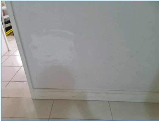
Foto 7 – Vista nos reparos necessários de pintura do apartamento
