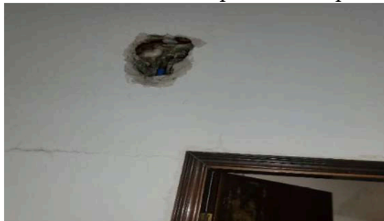
foto 18 buraco no teto precisa de reparo
