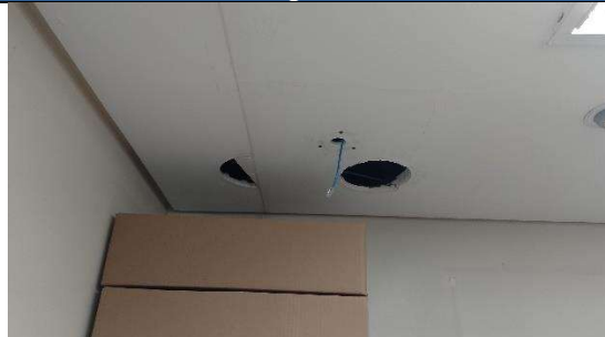
FOTO Teto gesso avariado
