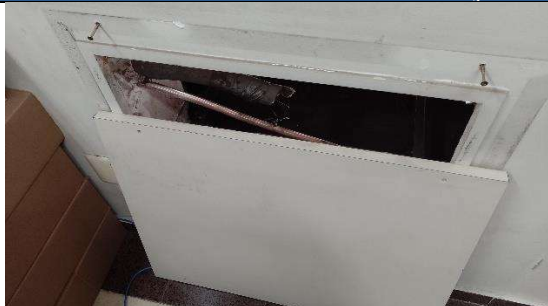
FOTO – Parede – Quadro de manutenção
