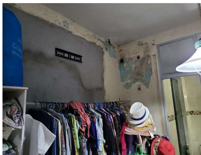
Detalhe de patologia - suíte nº 2
