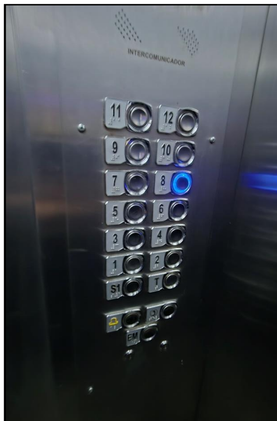
Ilustração 26: Vista interna das áreas comuns do empreendimento residencial denominado “CONDOMÍNIO GREEN PEACE” – Pannel dos elevadores de serviço e social
