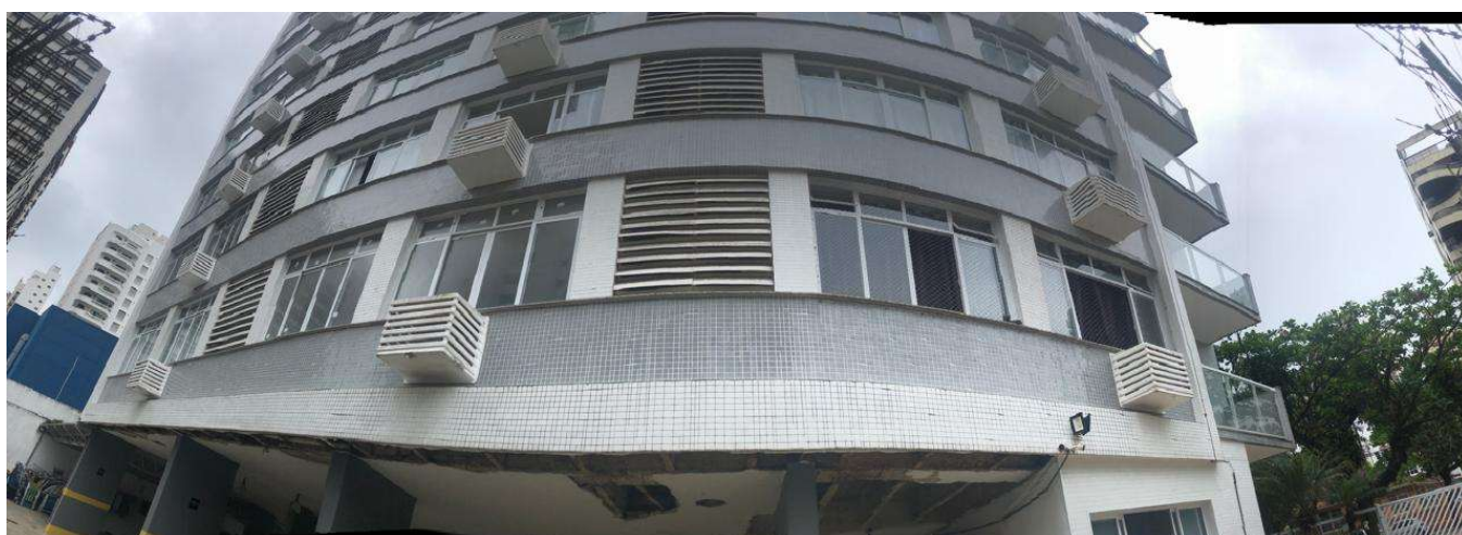
Figura 37 – Vista da lateral do Edifício Ubatuba revelando forro aberto e obra de manutenção.
