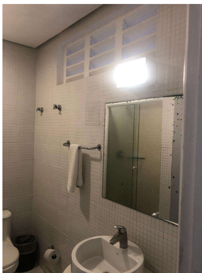
Figura 26 – Detalhe abertura do banheiro para o externo.
