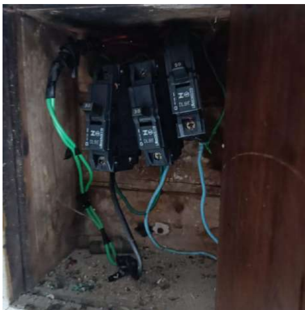
Foto 11 - QUADRO DE LUZ
