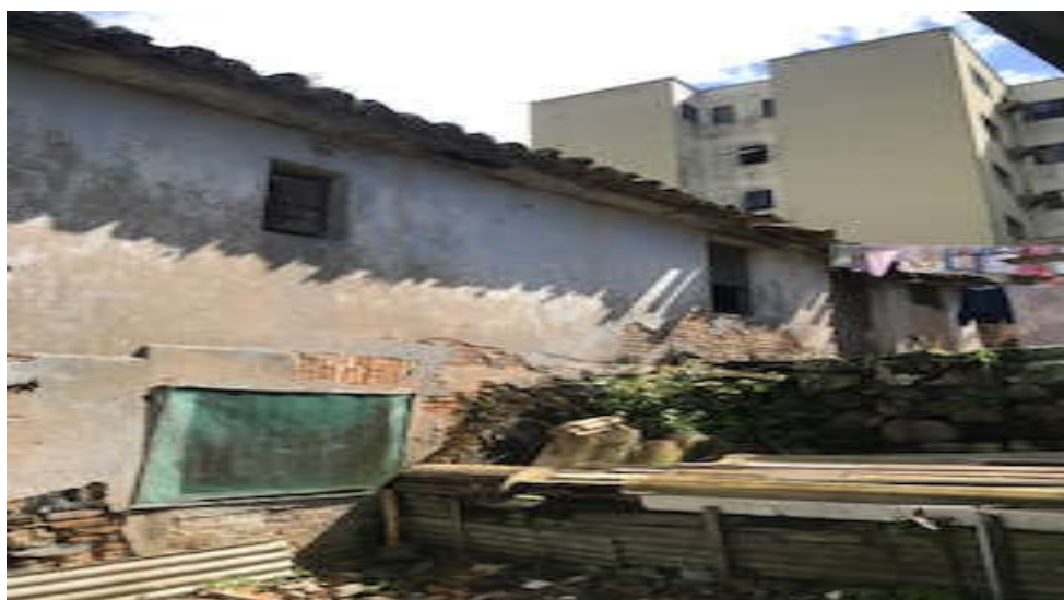
IMAGEM Nº 6 – DA CASA DOS FUNDOS (péssimas condições de uso)
