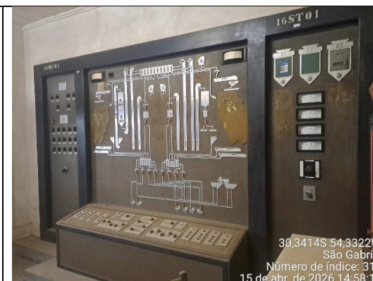
Foto 24 – Painel de Controle
