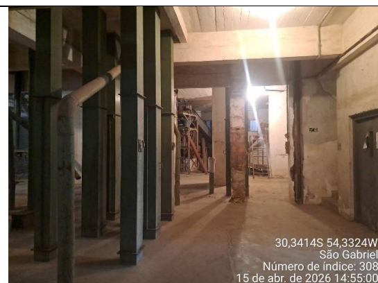
Foto 19 – Vista interna (pav. Térreo) Central de Beneficiamento – elevadores de canecas (elevador de caçambas)
