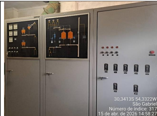
Foto 25 – Quadro de Comando
