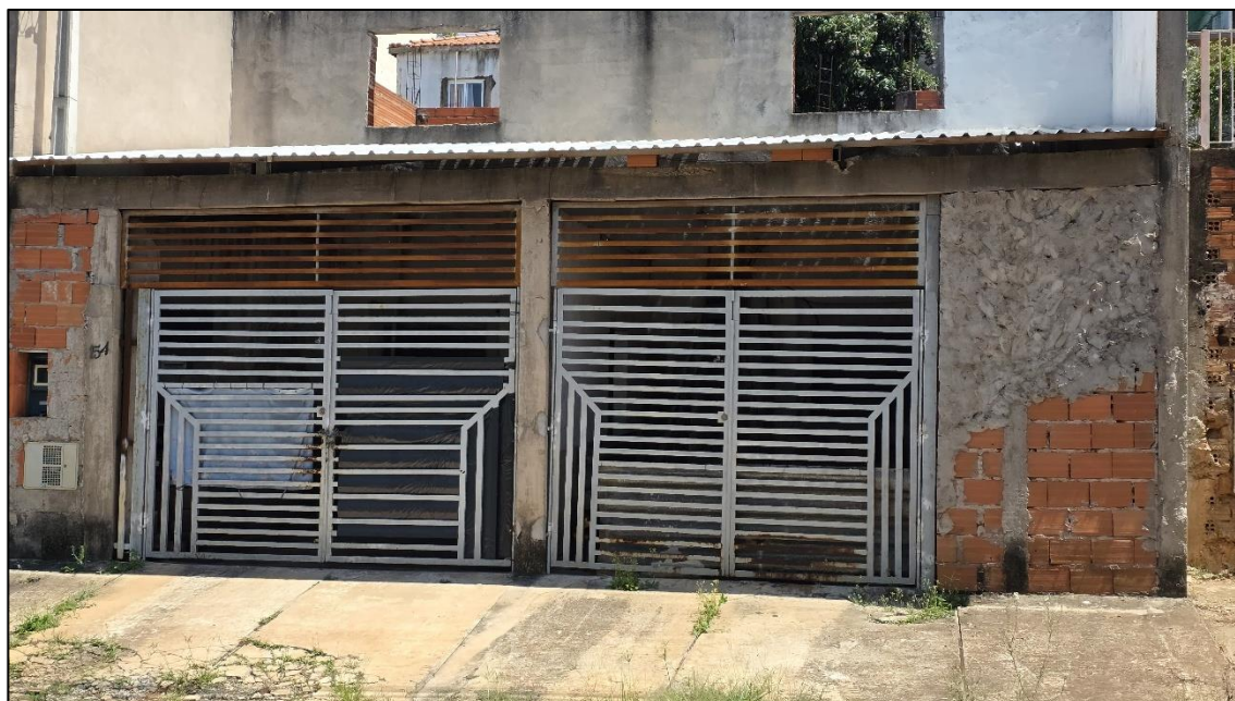
Imagem 12: Portão deteriorado com marcas de ferrugem.
