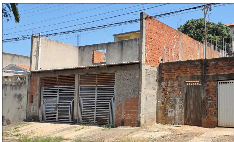
Imagem 11: Piso superior inacabado e alvenarias com tijolos aparentes. Telha metálica instalada na parte da frente.
