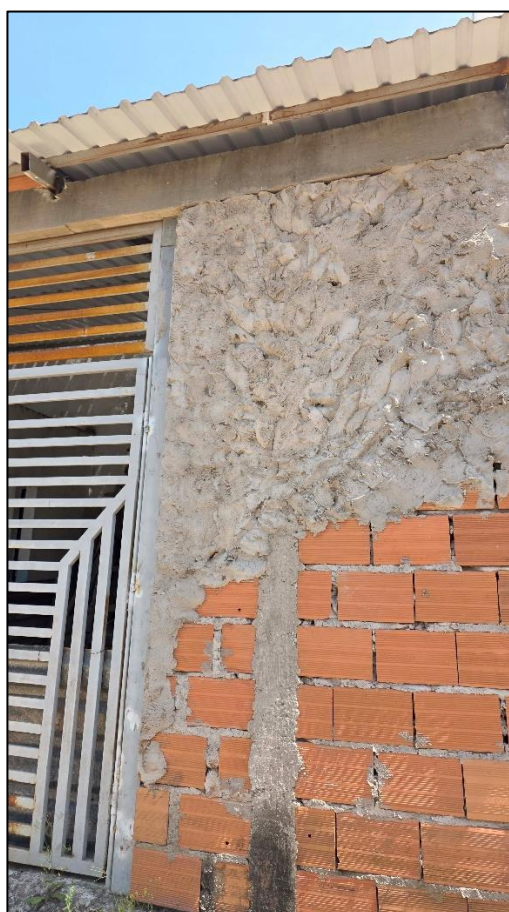
Imagem 13: Fachada lateral parcialmente rebocada com tijolos aparentes.
