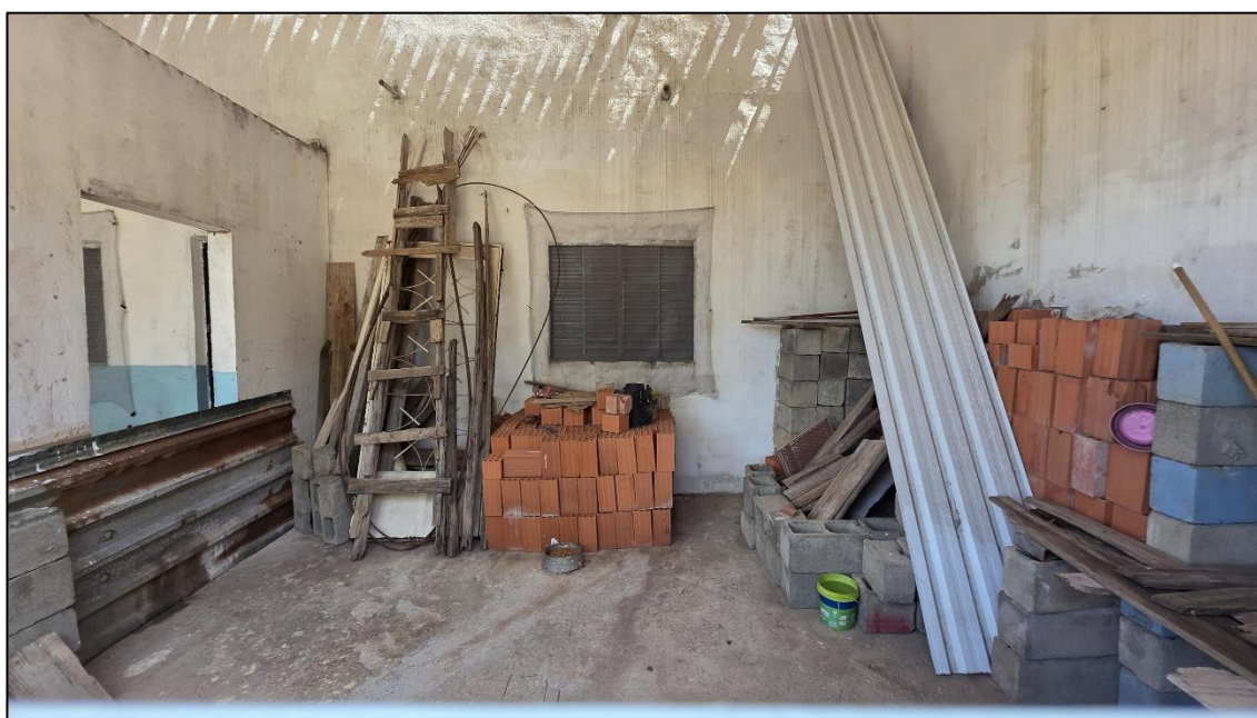
Imagem 09: Vista da garagem inacabada, com materiais de construção, piso em concreto, paredes com reboco e pintura. Presença de marcas de infiltrações pelo sistema de cobertura e pintura deteriorada.
