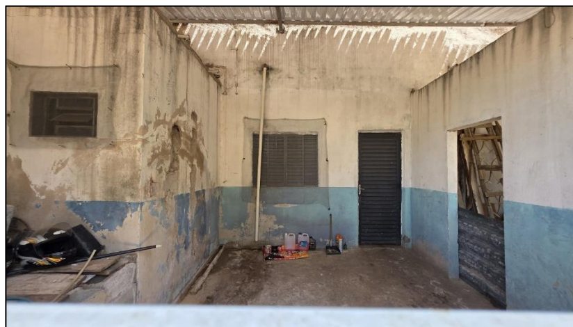
Imagem 10: Vista da entrada inacabada, com materiais de construção, piso em concreto. Reboco deteriorado nas paredes. Presença de marcas de infiltrações pelo sistema de cobertura e pintura deteriorada. Esquadrias de ferro.
