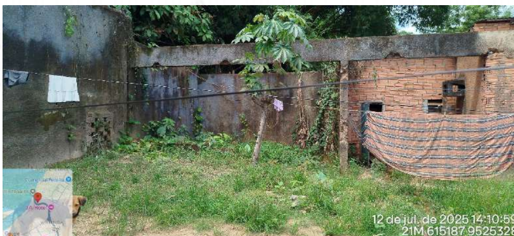
Foto 7 - Ruínas da antiga estrutura em concreto
