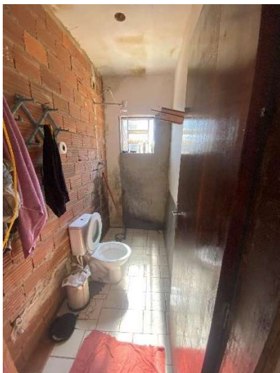
Foto N.08 – Área Interna da Residencia – WC Interno. Piso Cerâmico, sem azulejos e com Laje.
