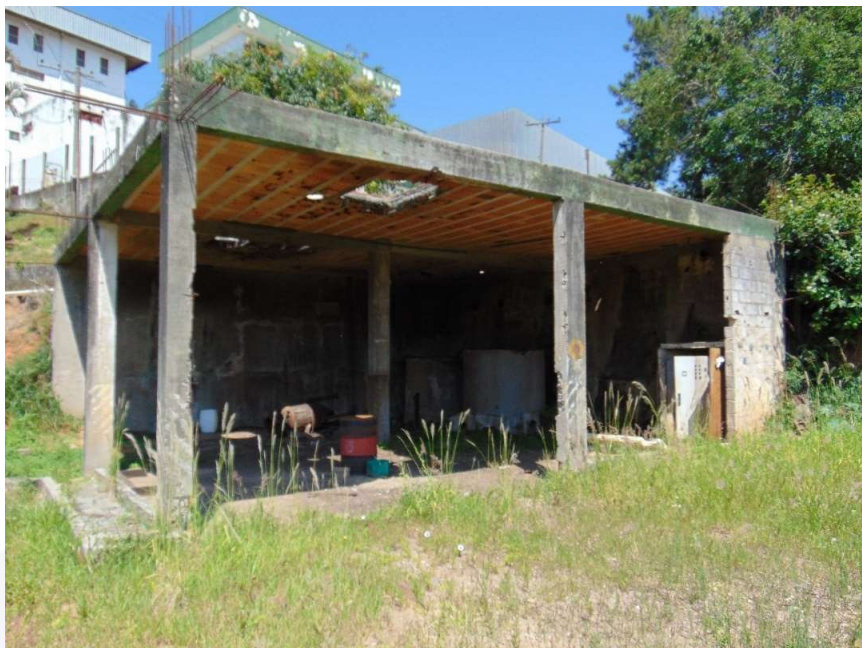
Figura 4.10 Edificação 1 com sinais de abandono e estado de ruína
