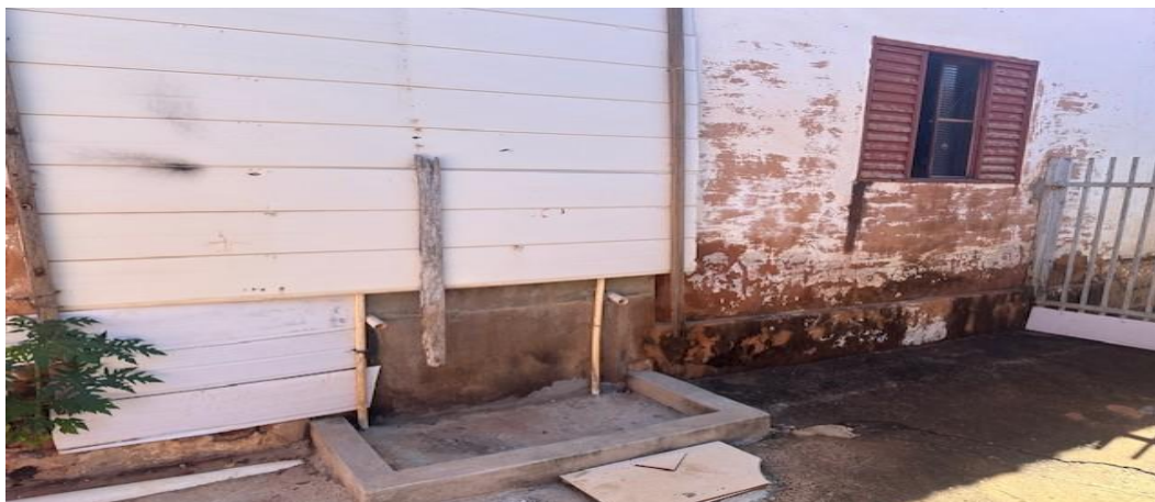
Foto 3 – Parede da residência vizinha onde se verifica a água do tanque caindo diretamente no terreno do imóvel e ainda a parede fora improvisada com placas de pvc.
