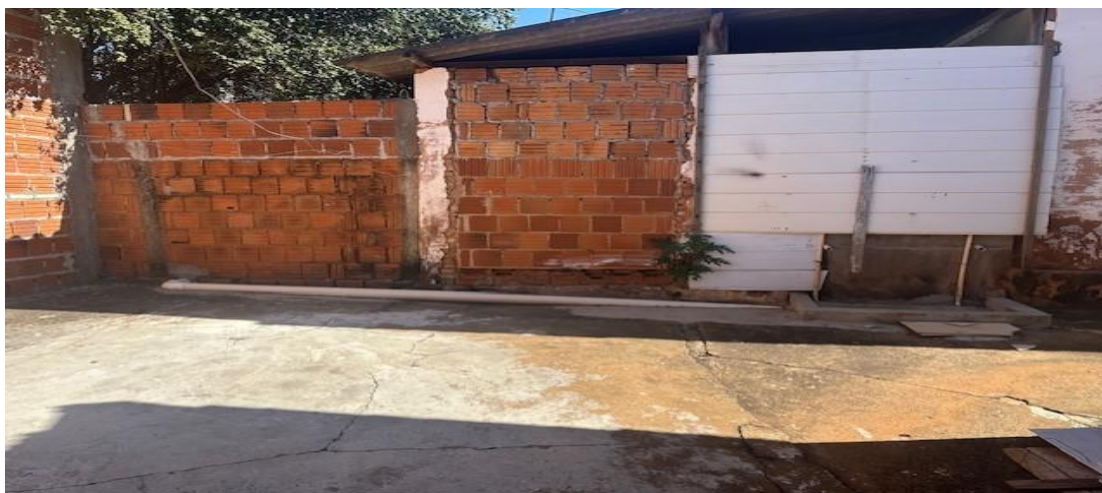
Foto 2 – Parede de divisa do lado direito onde se verifica que o esgoto da residência vizinha passa pelo terreno do imóvel objeto da ação.
