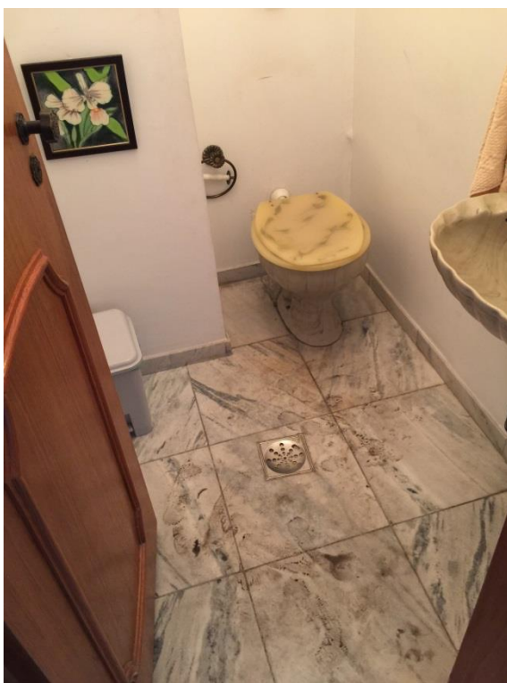
Figura 21: Lavabo do piso superior.
