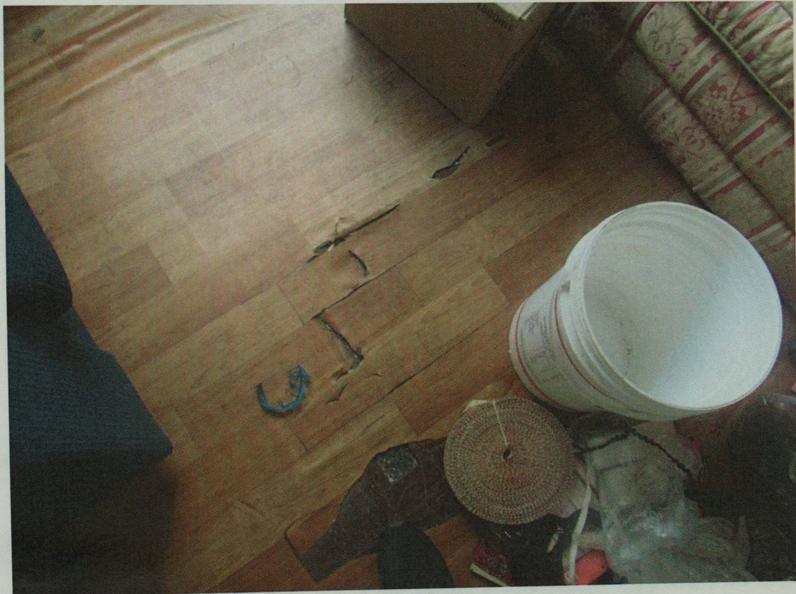
Acima é possível verificar os danos no piso da sala.
