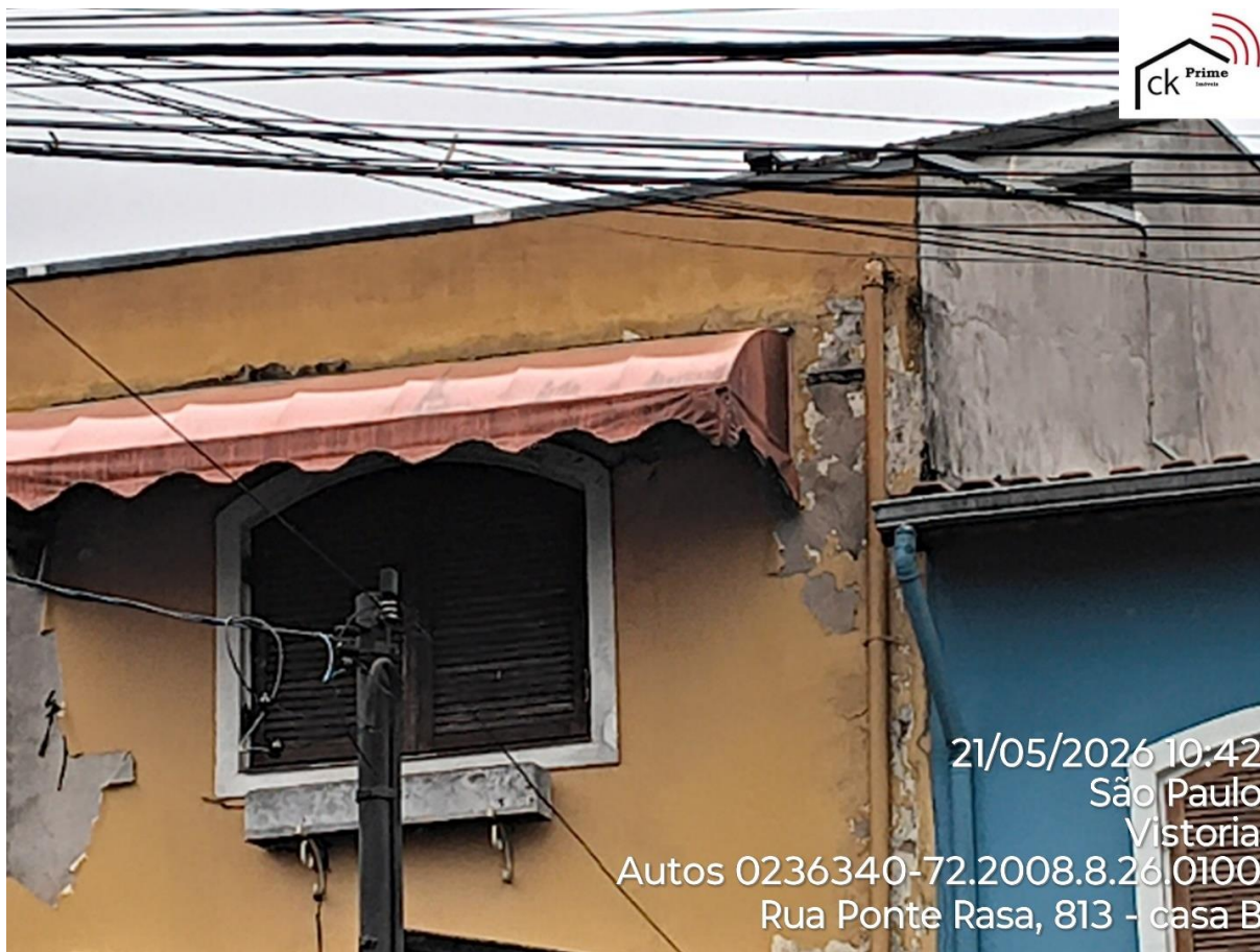
Foto 10 – Detalhe infiltração e destacamento da argamassa externa.
