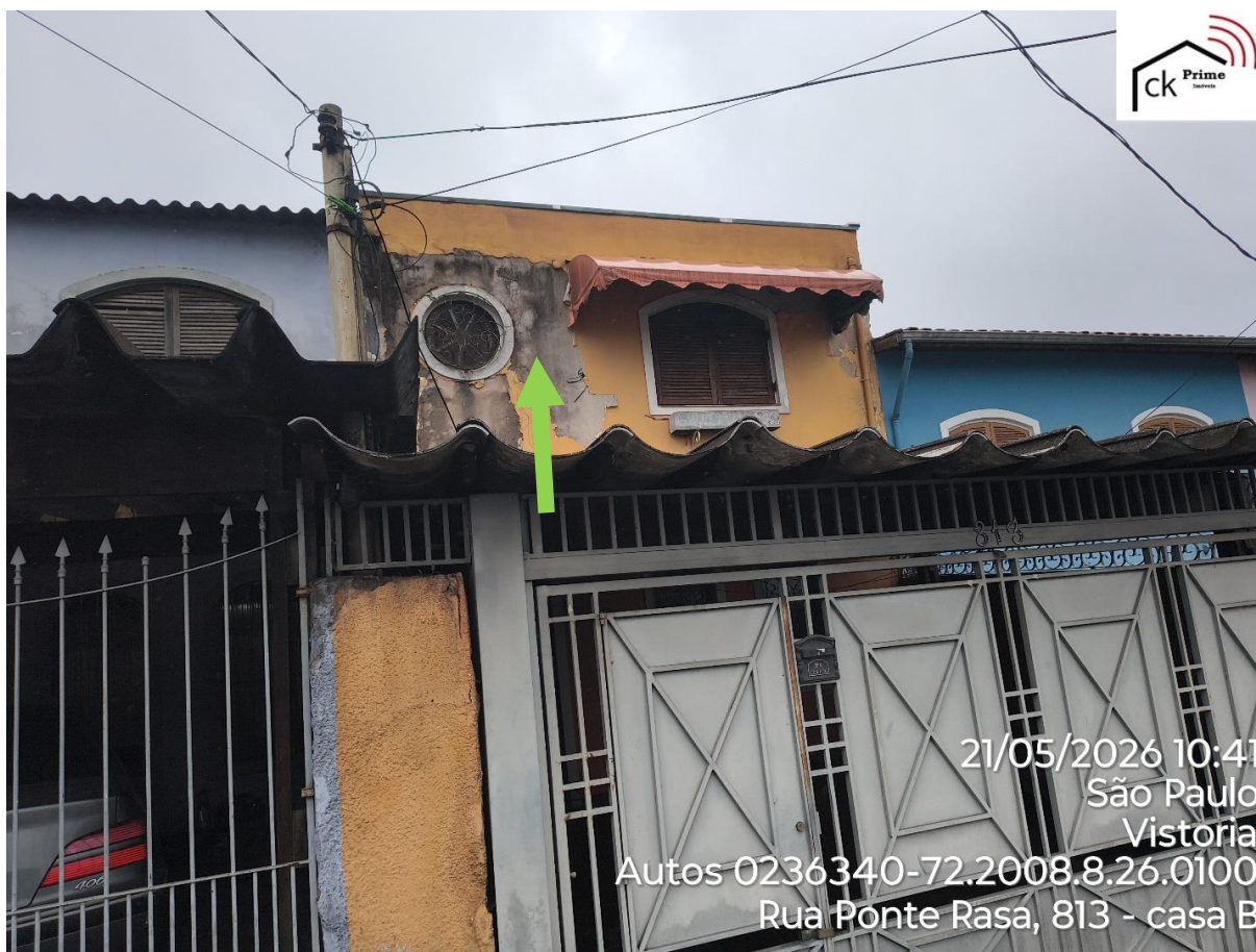
Foto 7 - Fachada do imóvel e garagem onde visualizamos infiltração e destacamento da argamassa externa (seta verde).
