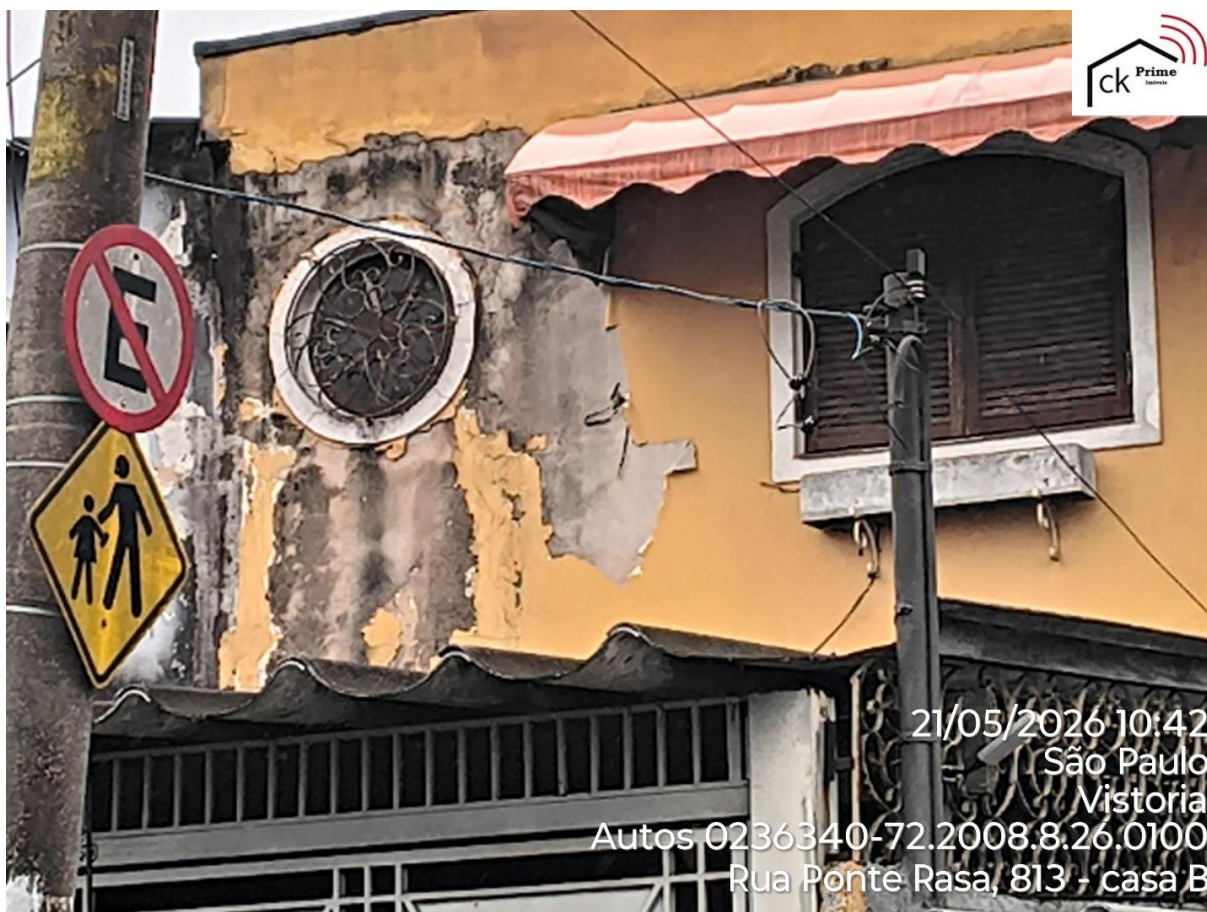
Foto 8 – Detalhe infiltração e destacamento da argamassa externa.
