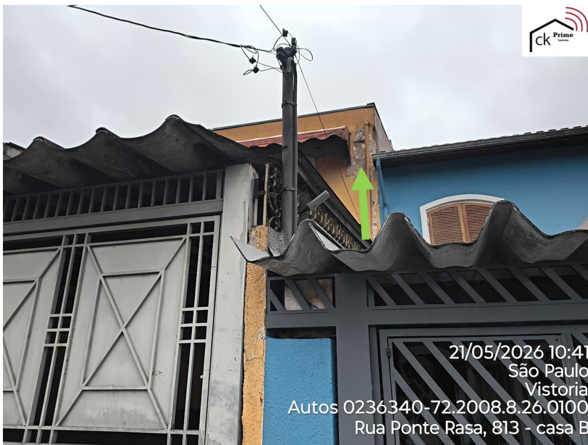
Foto 9 – Fachada do imóvel e garagem onde visualizamos infiltração e destacamento da argamassa externa (seta verde).
