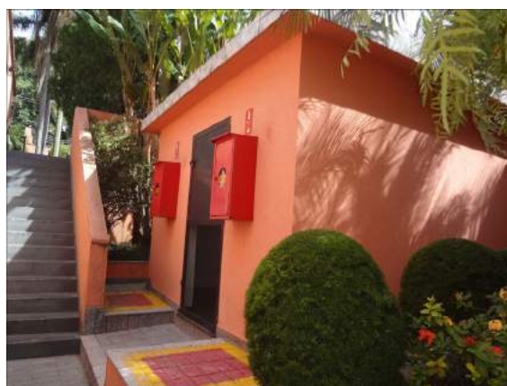
FOTO 47- Sala do Gerador.
