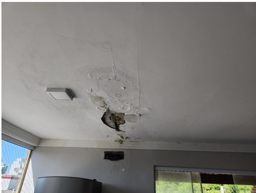
Dano no forro de gesso em mais detalhes.
