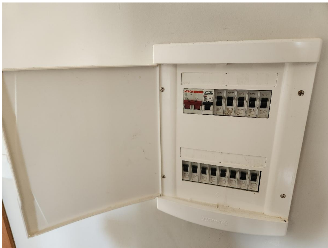
Quadro de distribuição elétrica do apartamento.
