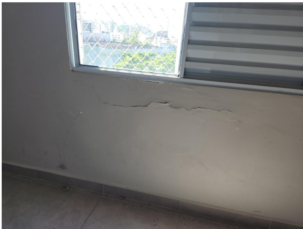
Pintura danificada abaixo do caixilho.
