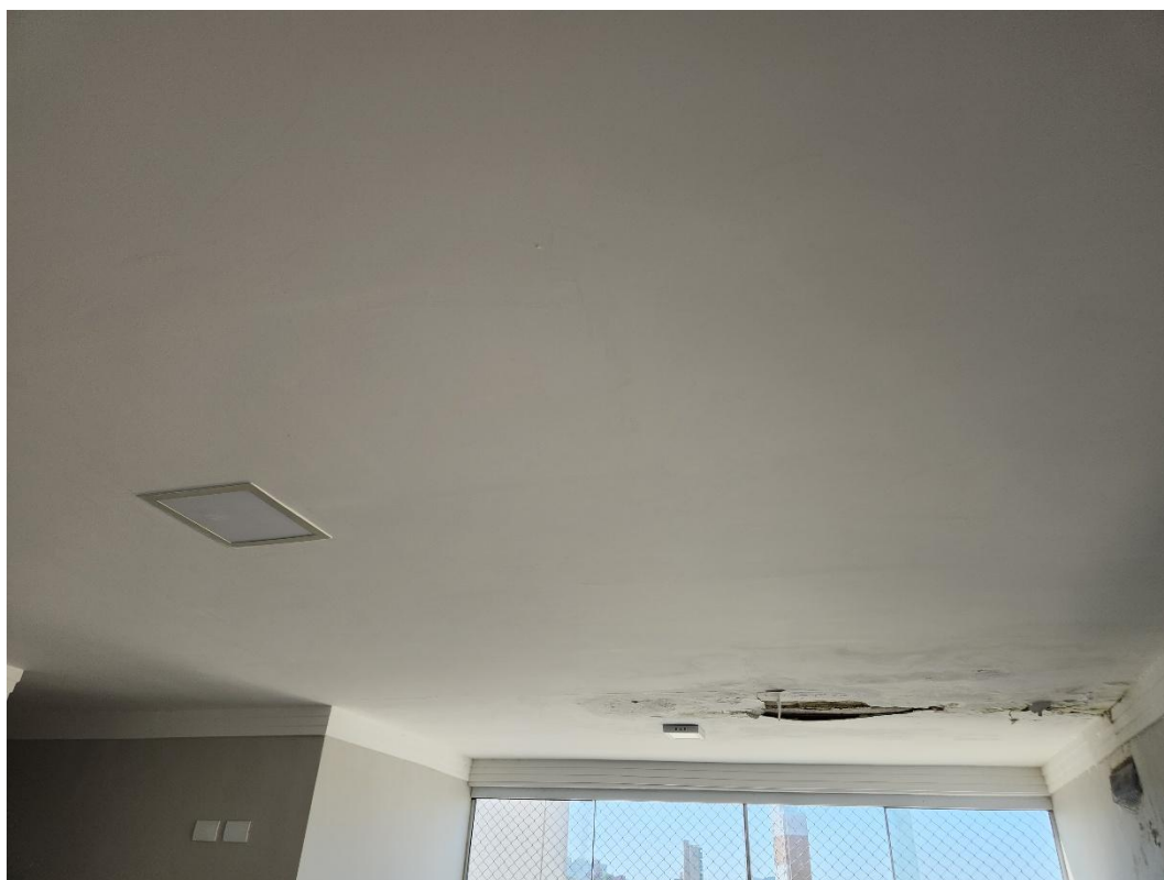
Forro em gesso com iluminação embutida – nota-se danos por umidade.
