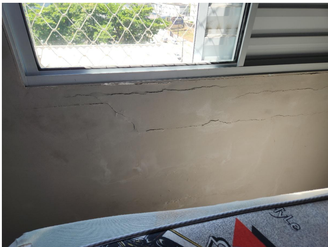
Pintura danificada abaixo do caixilho do dormitório.
