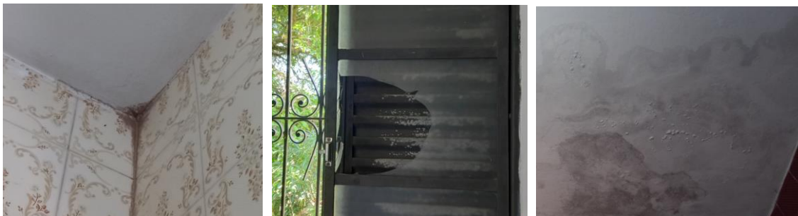
Fotos 24, 25 e 26: Vistas das patologias da Casa Principal.
