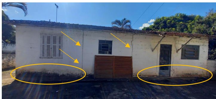
Foto 37: Vistas das patologias da Casa do Caseiro
