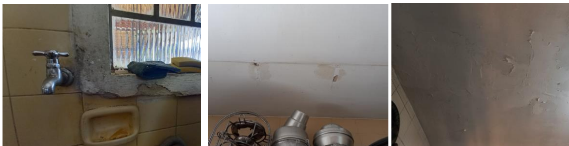
Fotos 18, 19 e 20: Vistas das patologias da Casa Principal.
