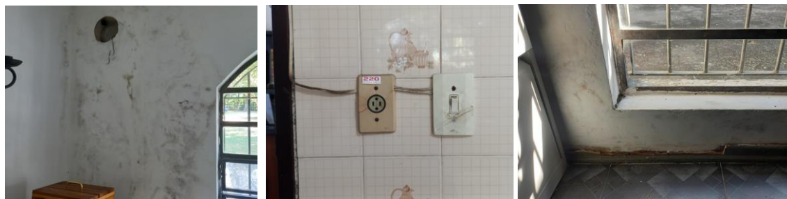
Fotos 21, 22 e 23: Vistas das patologias da Casa Principal.
