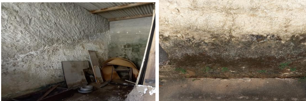
Fotos 30 e 31: Vistas das patologias dos Depósitos
