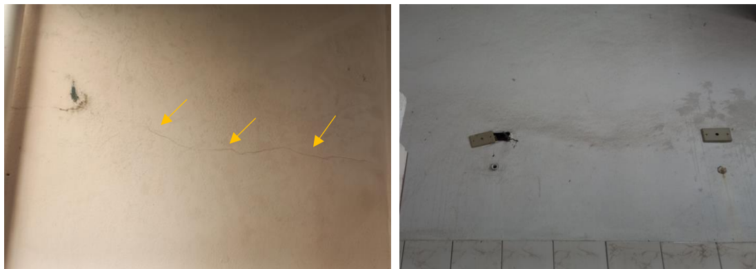
Fotos 55 e 56: Vistas das patologias dos Vestiários.
