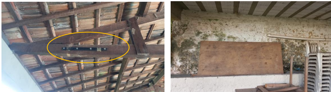
Fotos 59 e 60: Vistas das patologias do Rancho sem Churrasqueira.
