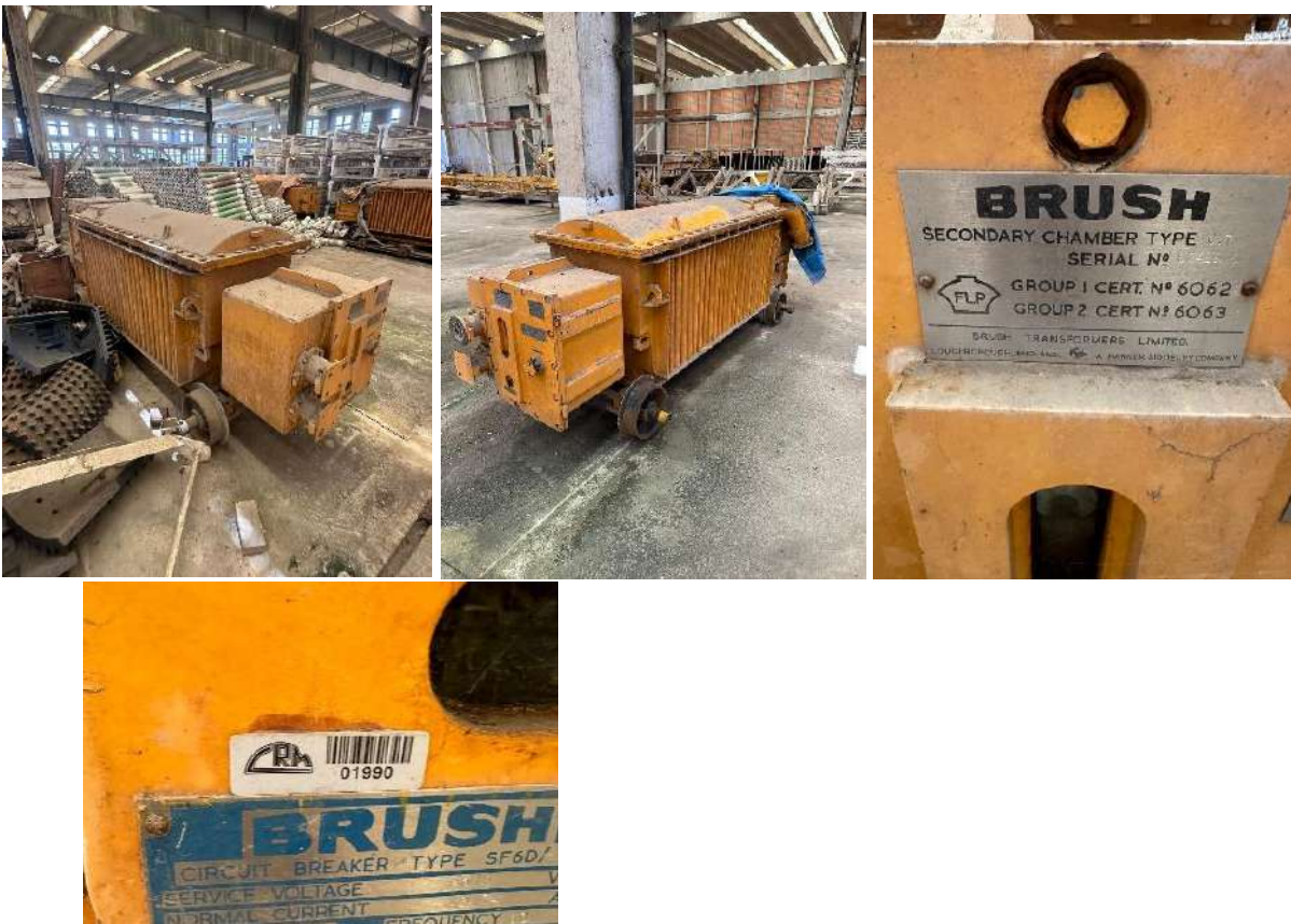
44) Dois transformadores alpine – patrimônio de um deles: 01990
