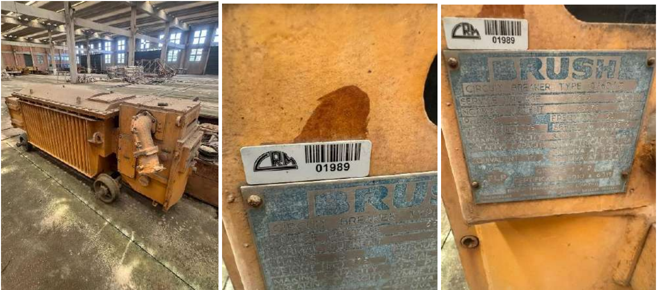
43) Um transformador alpine, patrimônio 01989
