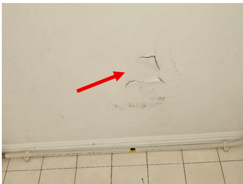
Imagem 14 – Detalhe aproximado para ponto com destacamento da pintura no teto da área de serviço.
