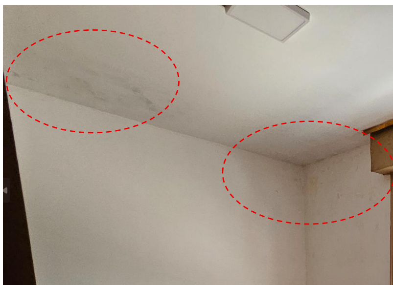
Imagem 7 – Detalhe aproximado para manchas de umidade nas paredes e teto do dormitório II.
