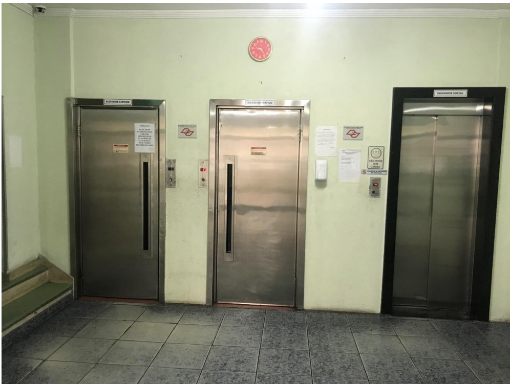
Foto 5 - Hall dos elevadores – 1 social e 2 de serviço
