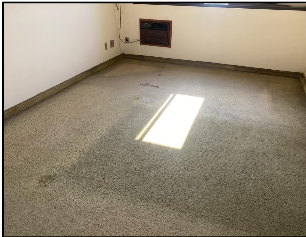
Foto 55: Suíte Master, carpete danificado
