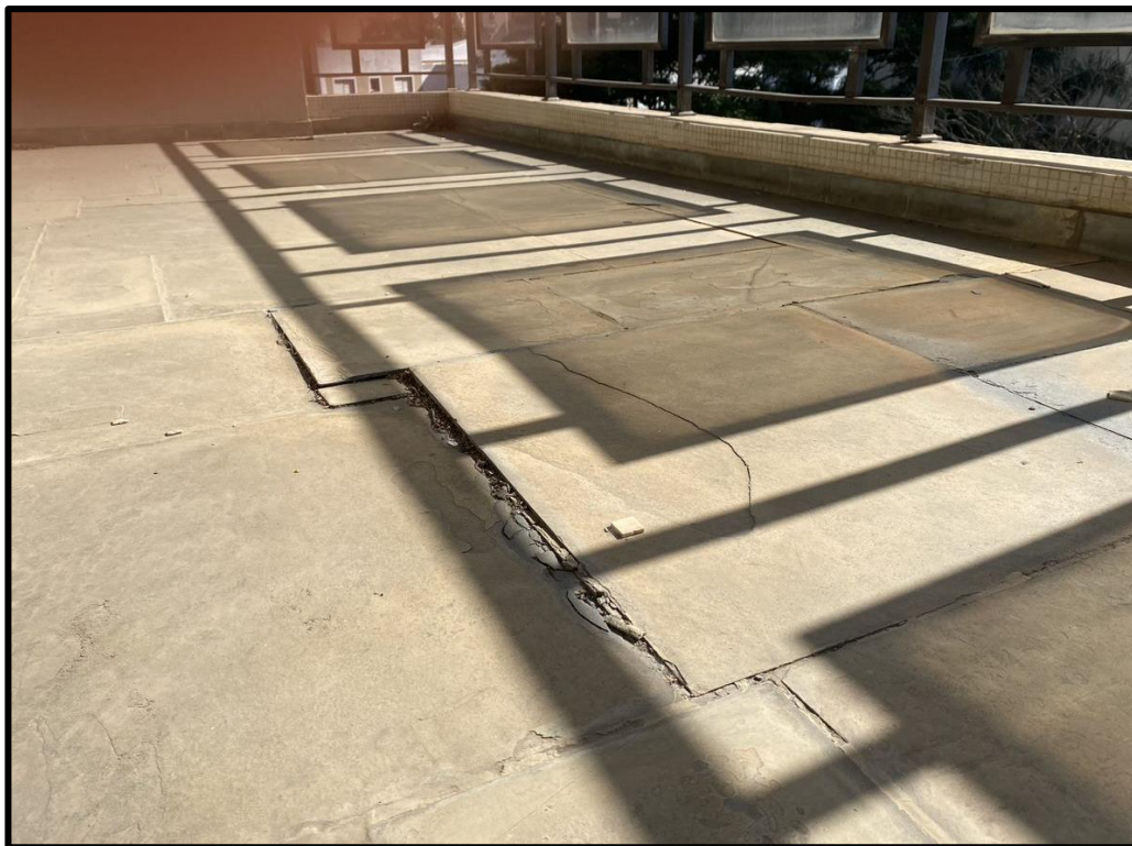
Foto 21: Piso da varanda danificado
