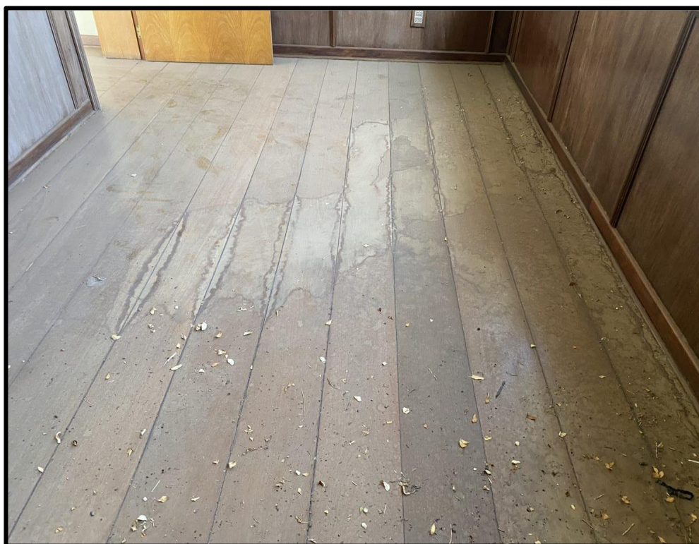
Foto 17: Piso escritório danificado
