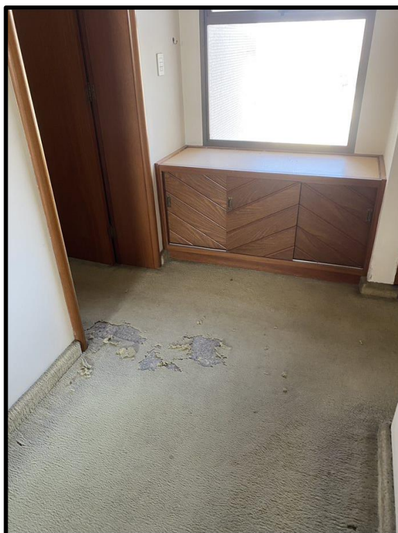
Foto 37: Acesso aos dormitórios com carpete danificado
