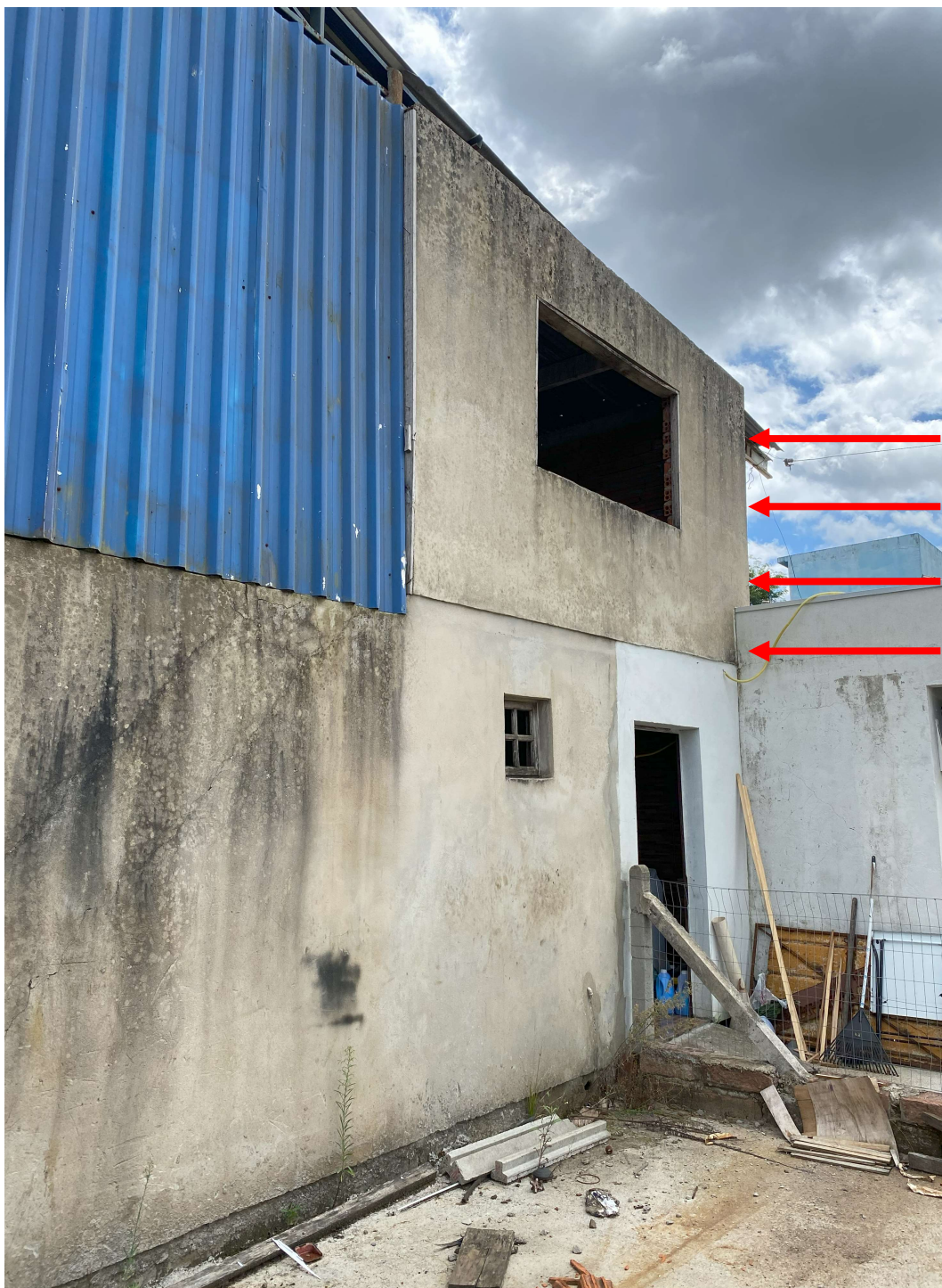
Figura número 5 – Verifica-se que as edificações das matrículas 14.790 (pavilhão industrial à esquerda) e 14.789 (residência à direita) se encontram juntas. Conforme detalhado em vermelho, parte do mezanino do pavilhão industrial está sobre a área de serviços da residência, invadindo a área da matrícula nº 14.789.
