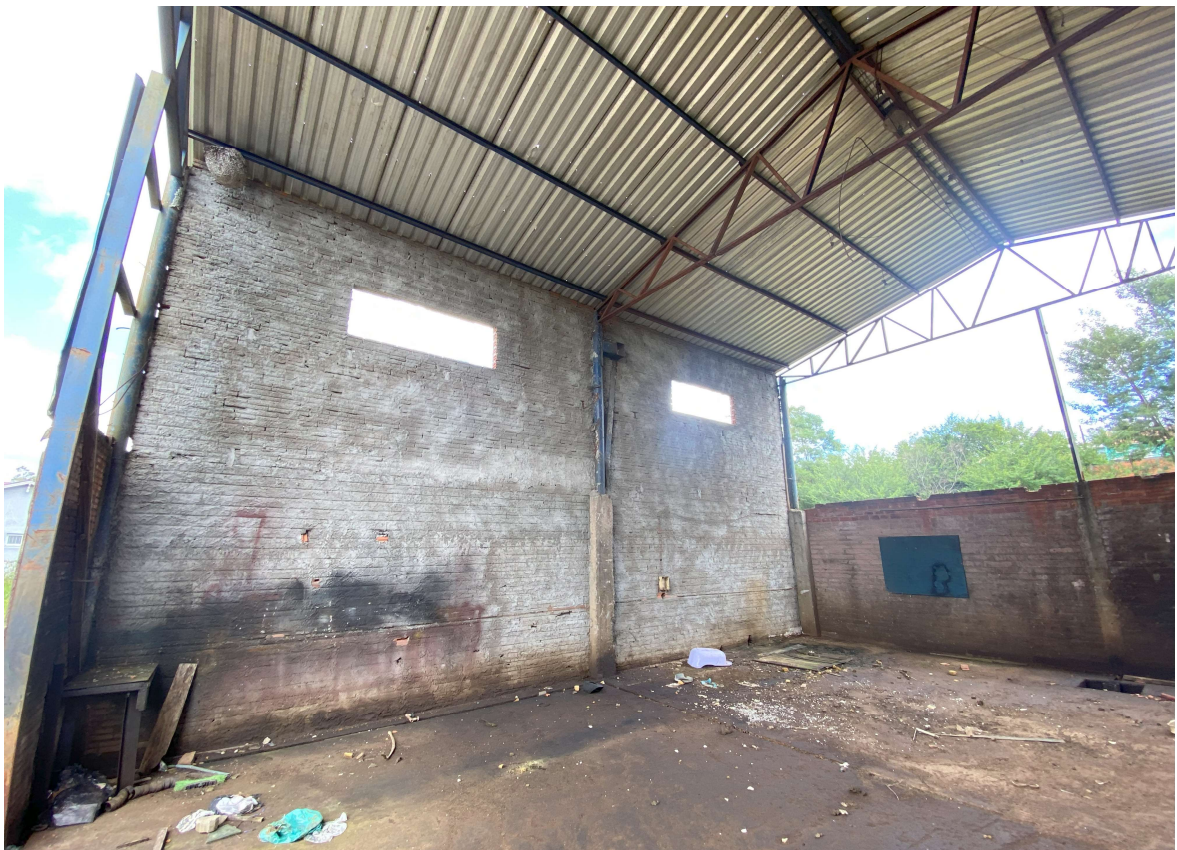
Figura número 4 – Interior do pavilhão industrial edificado na matrícula nº 14.790. A edificação encontra-se inacabada e em estado de abandono atualmente.
