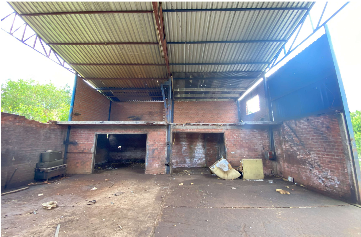
Figura número 3 – Interior do pavilhão industrial edificado na matrícula nº 14.790. A edificação encontra-se inacabada e em estado de abandono atualmente.
