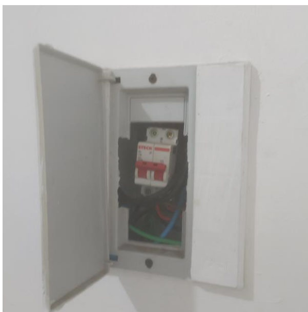
Foto 11 - QUADRO ENERGIA APARTAMENTO
