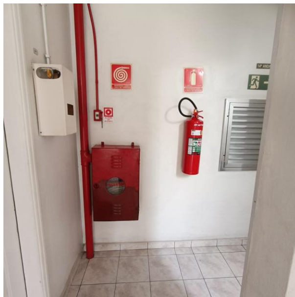
Foto 16 - SISTEMA DE INCENDIO
