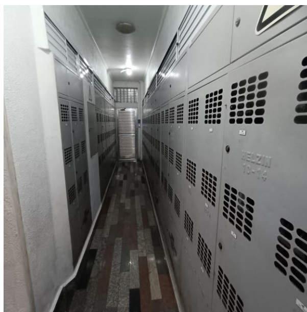
Foto 19 - QUADRO DE LUZ CENTRAL
