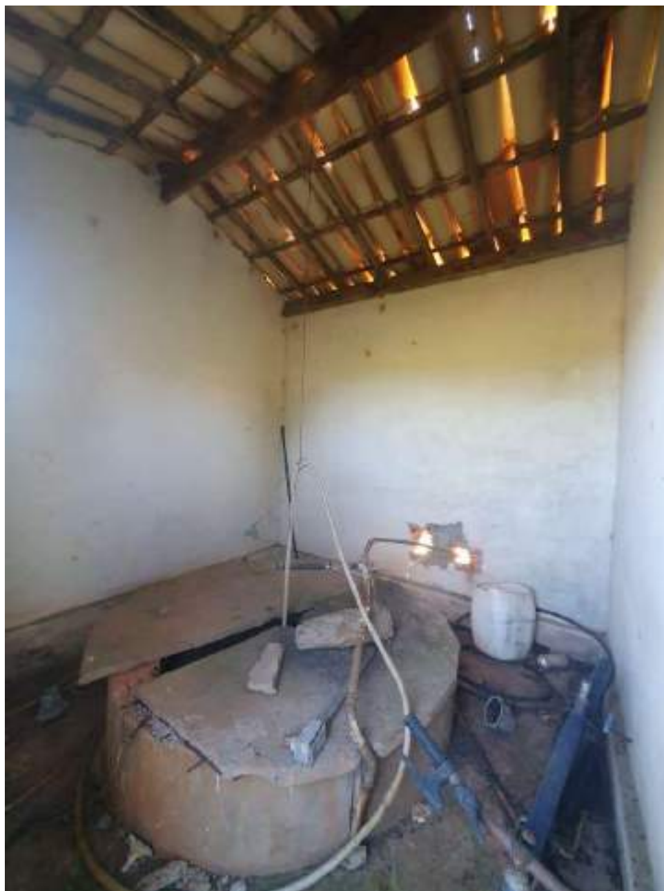
Foto 37 - Vista interna da casa de bombas
