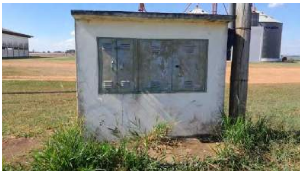
52 - Quadro de Distribuição Principal
