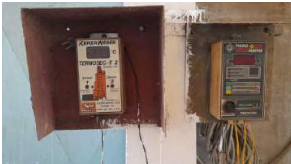
14 – Medidores de Temperatura e pressão do Secador
