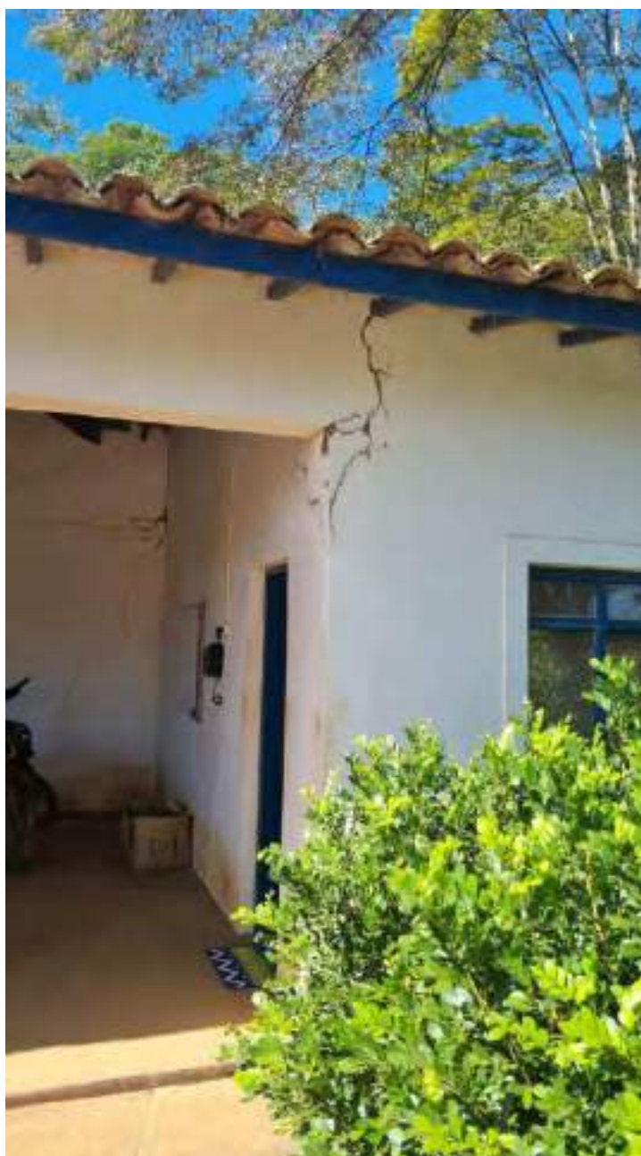
Foto 245 – Detalhe de rachadura na fachada do prédio 5
