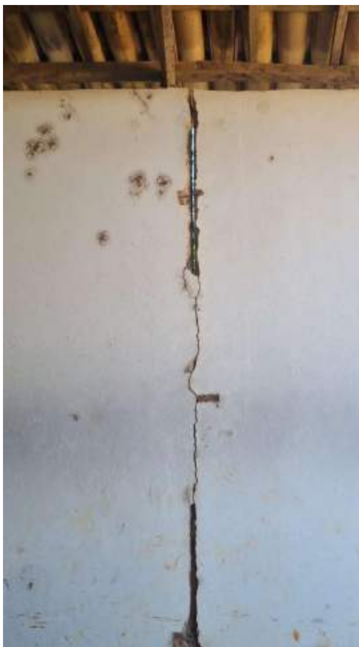
Foto 260 – Detalhe de rachadura na parede do prédio 8
