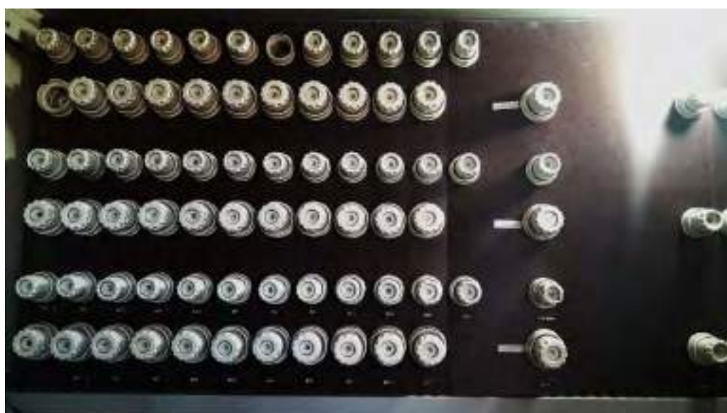
07 – Vista Interna – Painel Elétrico – Fusíveis Diazed
