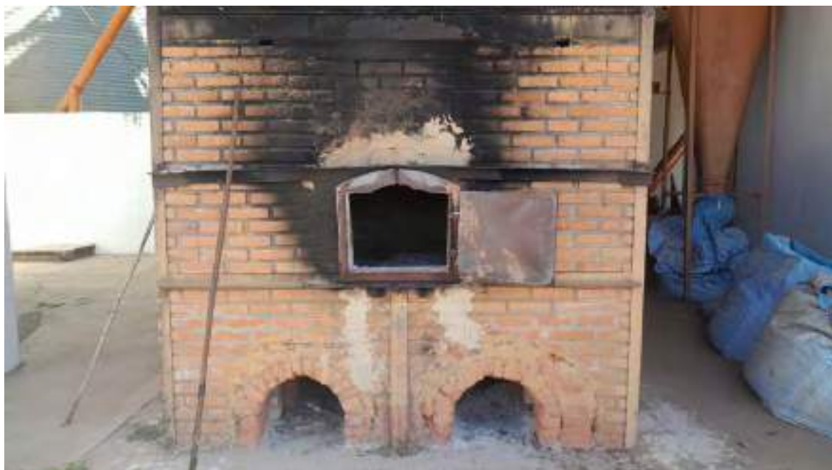
15 – Gerador de Calor para o Secador – Forno a Lenha
