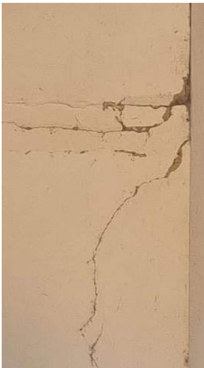
Foto 238 - Detalhe de rachadura na garagem do prédio 5
