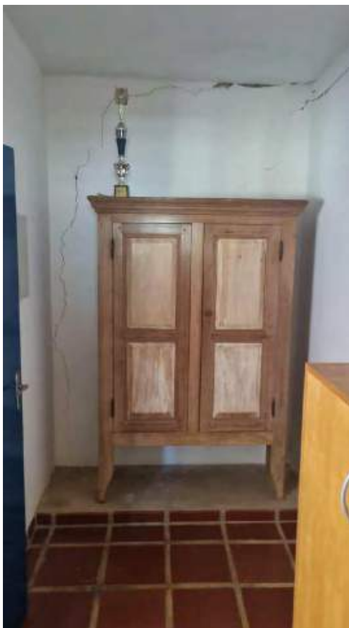
Foto 239 - Vista do hall de distribuição do prédio 5, administrativo, detalhe de trinca na parede
