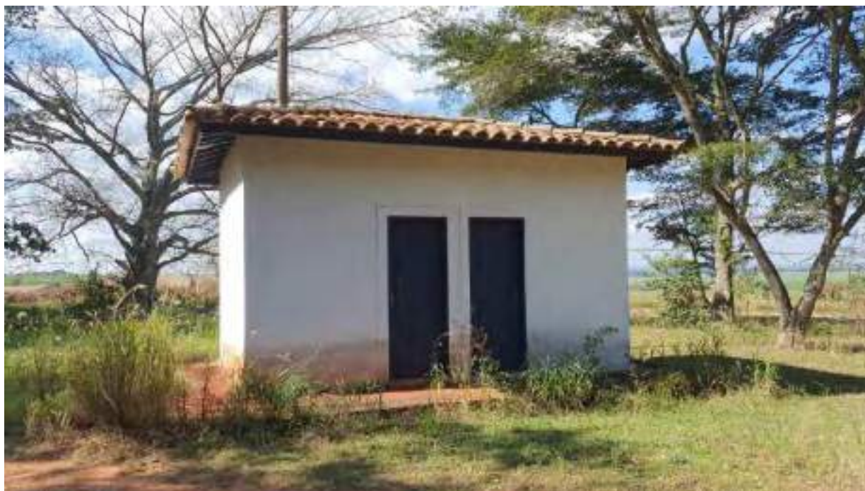
Foto 23 - Vista da cabine primária
