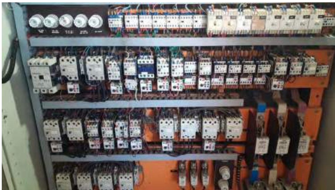
08 – Vista Interna – Painelelétrico – Fusíveis NH, Diazed, Contatores
