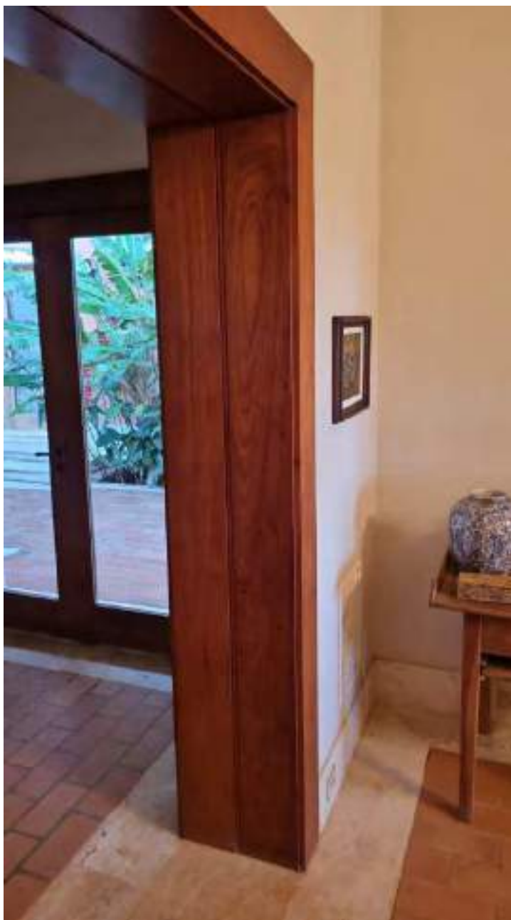
Foto 301 – Detalhe da parede dupla
