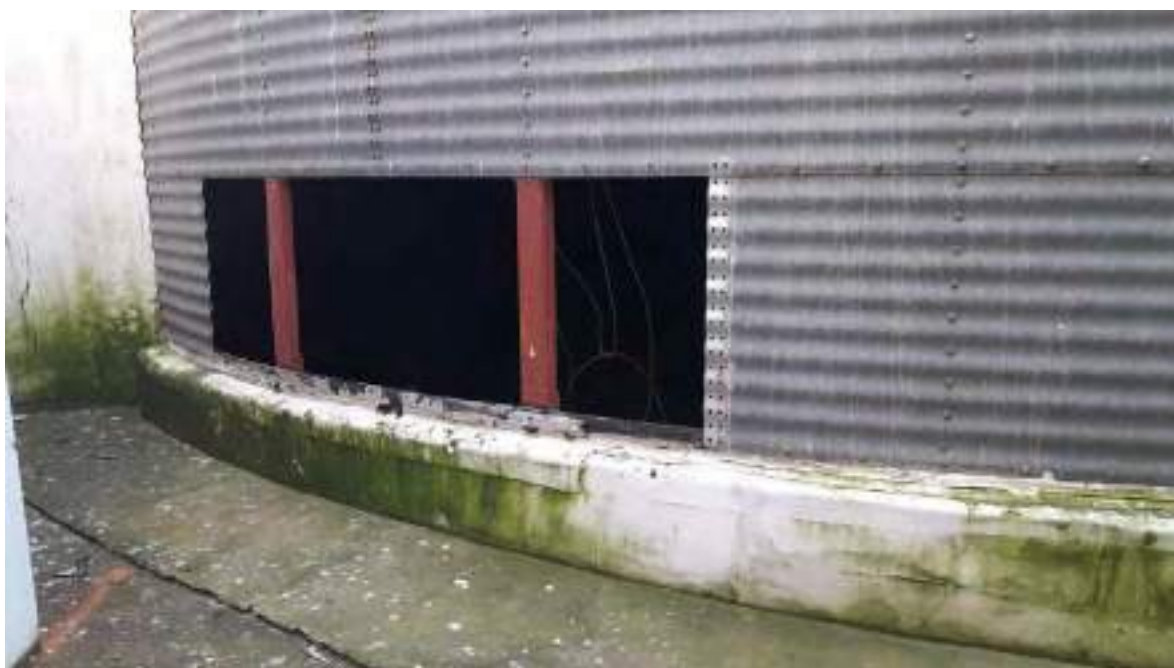
39 e 40 - Silo Kepler Weber – Avaria e problemas estruturais na base do silo
