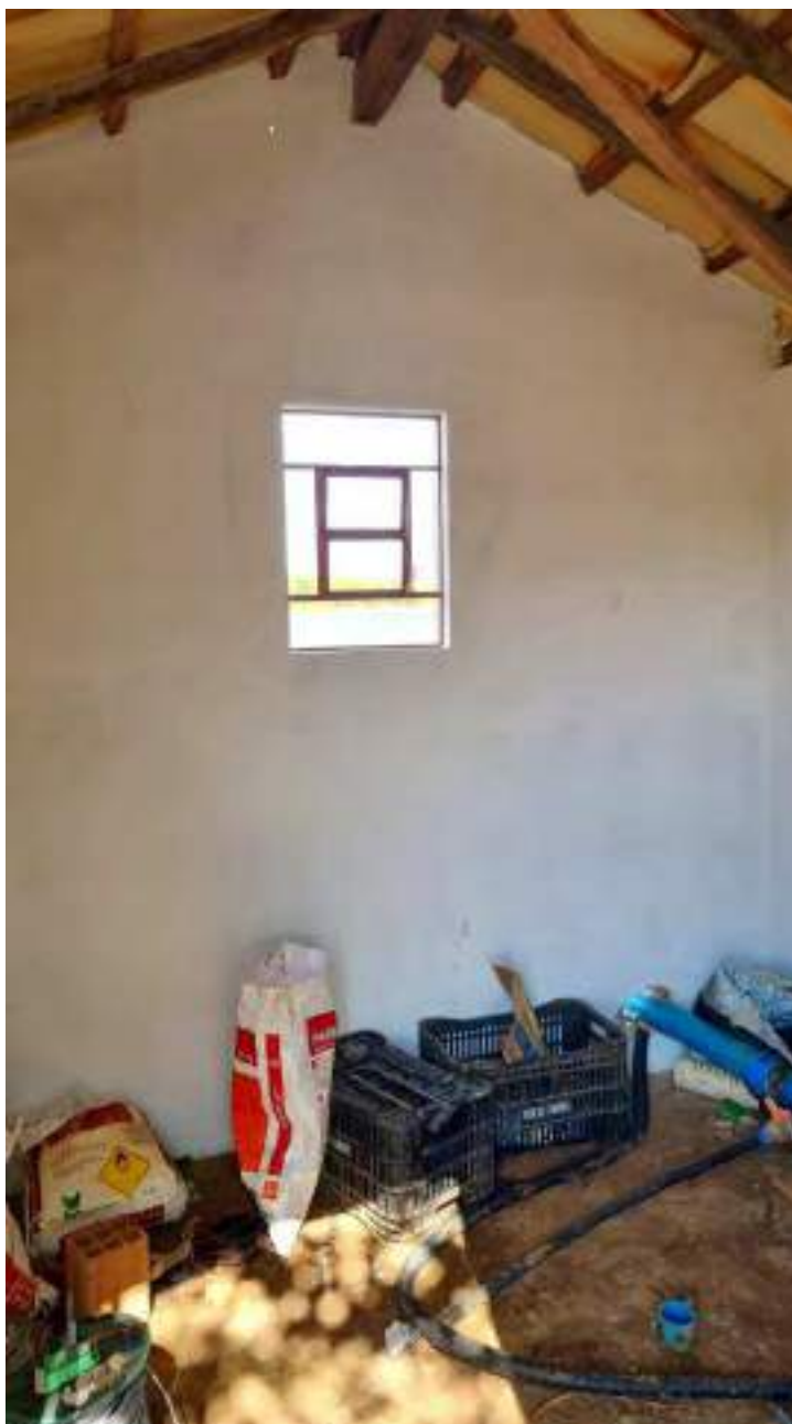
Foto 292 - Vista interna da casa de bomba e recalque
