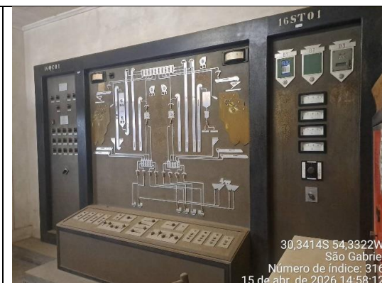
Foto 24 – Painel de Controle
