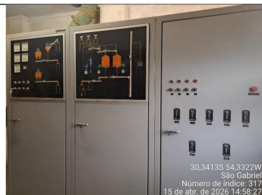
Foto 25 – Quadro de Comando
