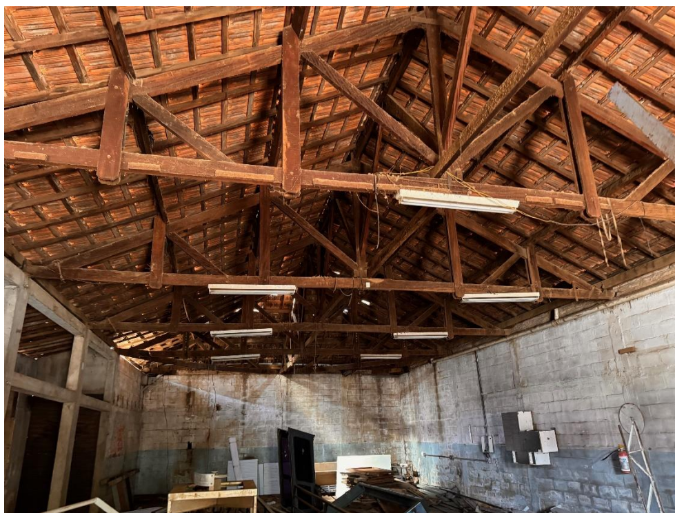
Foto 02. Detalhe da cobertura. Sem forro. Estado: mal conservado
