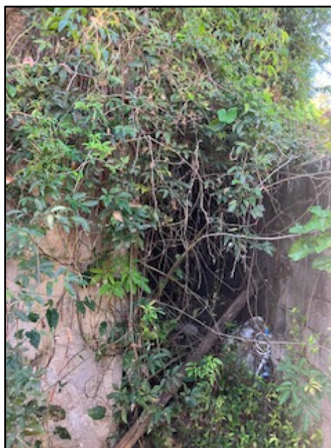
Figura 23- Edificação 4, coberta de vegetação (sem acesso)
