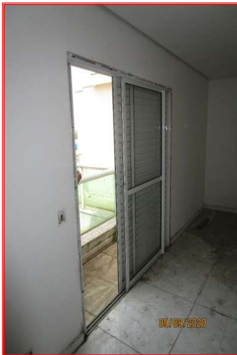
Foto nº 29: Vista parcial para o acesso ao terraço do 12º andar. A caixilharia necessita de revisão da sua vedação devido a ausência de manutenção.
