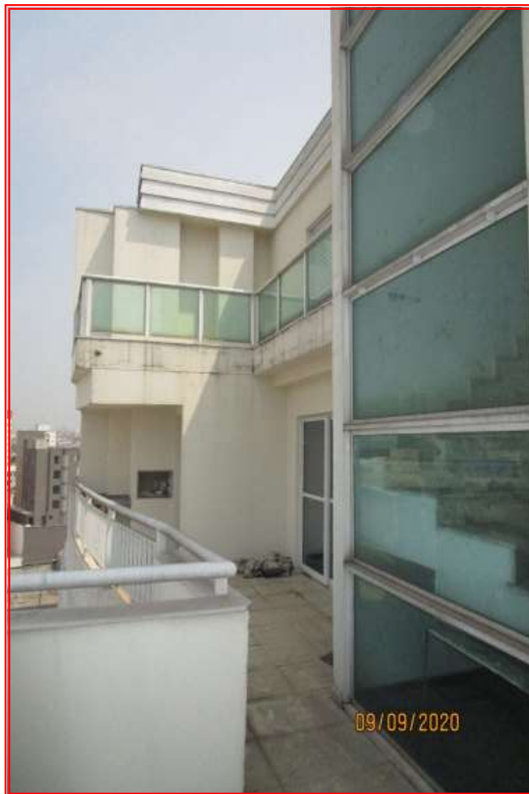
Foto nº 21: Vista do terraço descoberto, onde se observa a área “gourmet” com churrasqueira. Detalhe para o piso externo que necessita de revisão geral e substituição de peças cerâmicas, bem como a necessidade de pintura externa.
