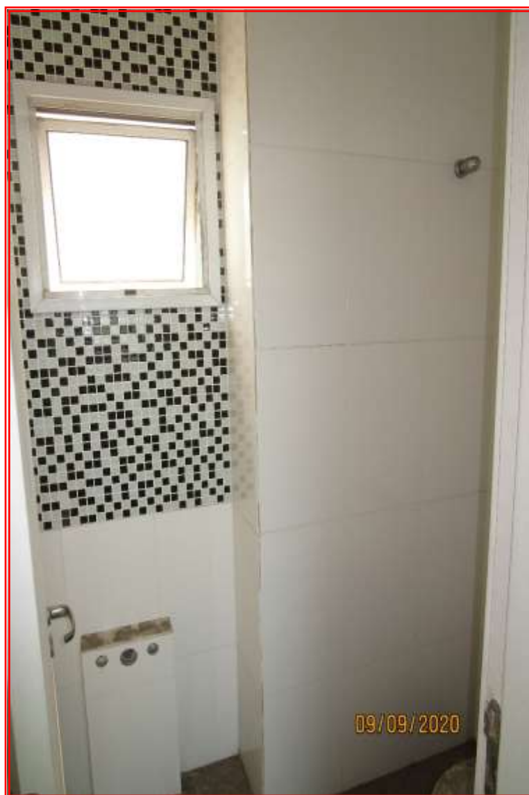
Foto nº 22: Vista parcial do lavabo, com obras inacabadas.
