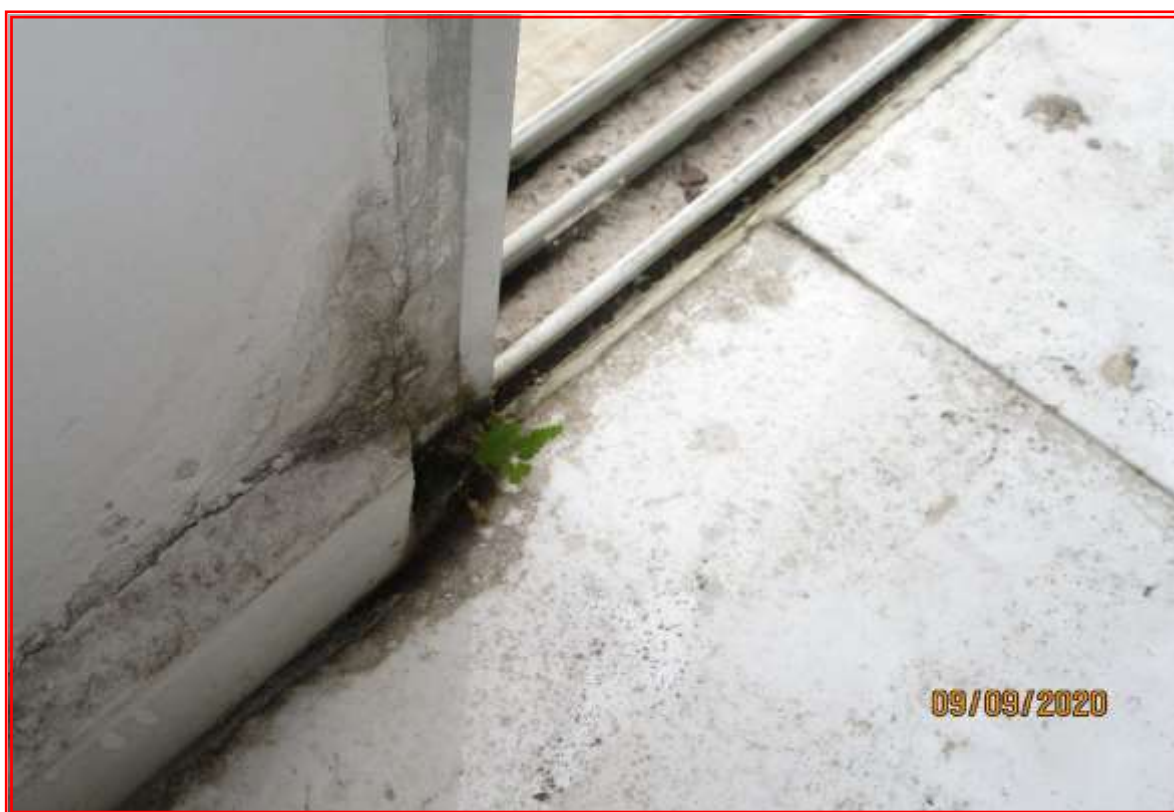
Foto nº 30: Detalhe para os vestígios de infiltração no dormitório 03 [suíte], provenientes da área externa.
