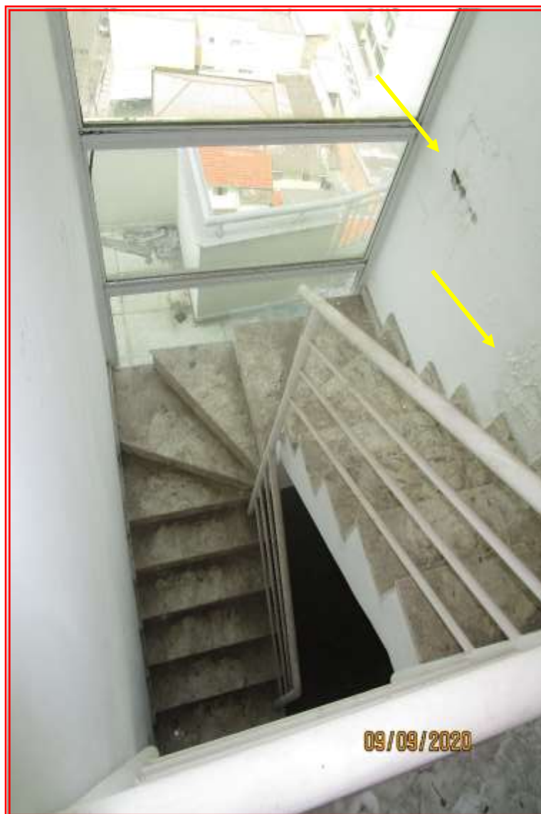
Foto nº 25: Escada de acesso ao andar superior do Duplex, onde se localizam os demais dormitórios e terraço, com detalhe para os vestígios de infiltração na parede. A caixilharia necessita de revisão da sua vedação devido a ausência de manutenção.
