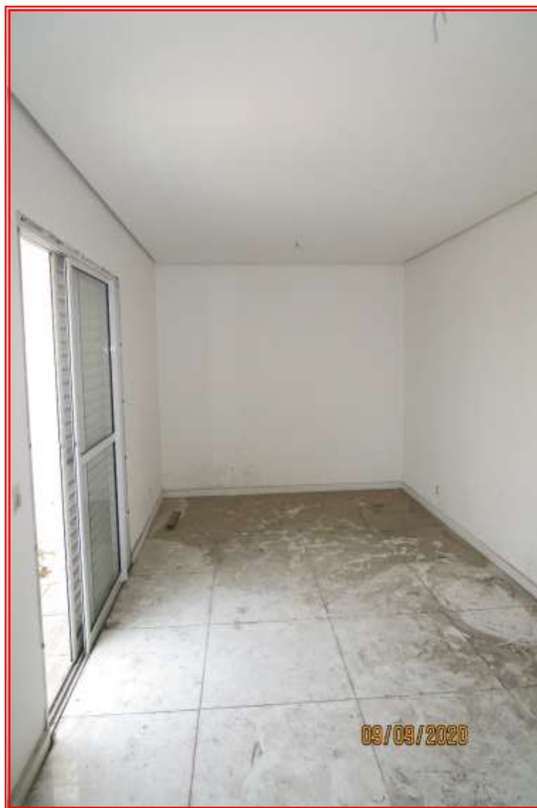
Foto nº 28: Vista parcial do dormitório 03 [suíte], com detalhe para os vestígios de infiltração na parede. A caixilharia necessita de revisão da sua vedação devido a ausência de manutenção.
