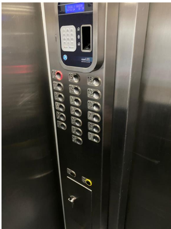
VISTA DO PAINEL DE CONTROLE DO ELEVADOR.
