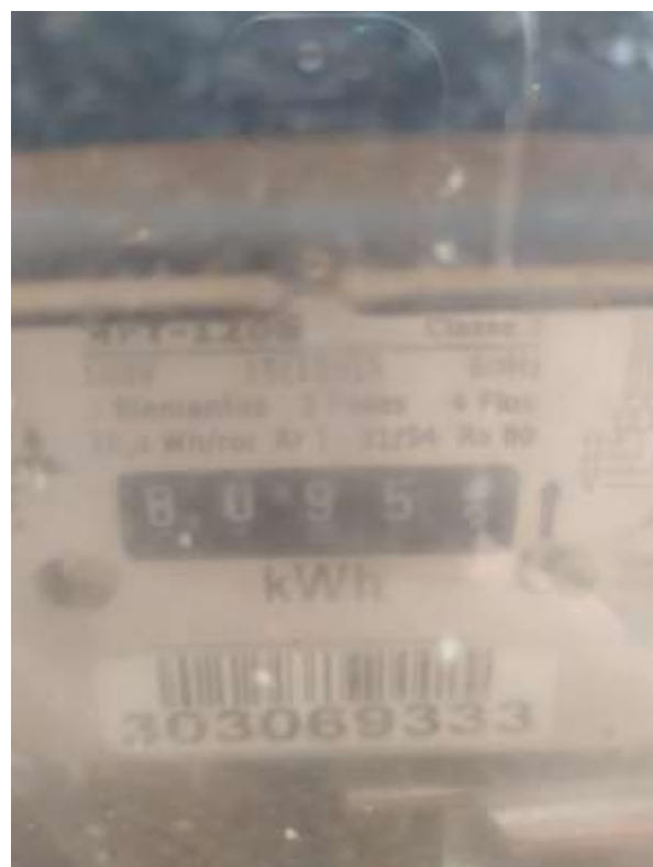
Figura 19 - LIGAÇÃO DE ENERGIA ELÉTRICA (C.P.F.L.)
