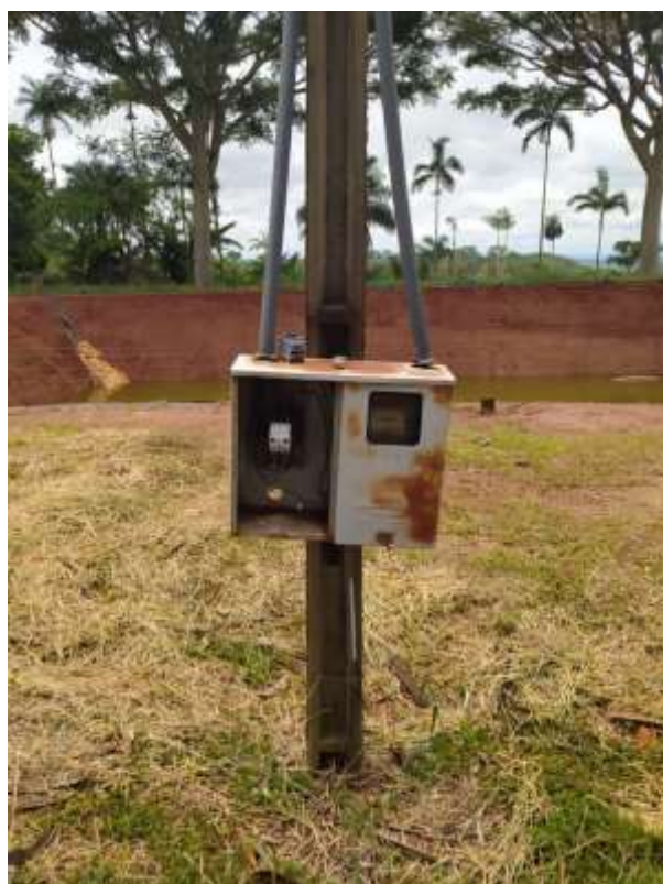
Figura 18 - LIGAÇÃO DE ENERGIA ELÉTRICA (C.P.F.L.)
