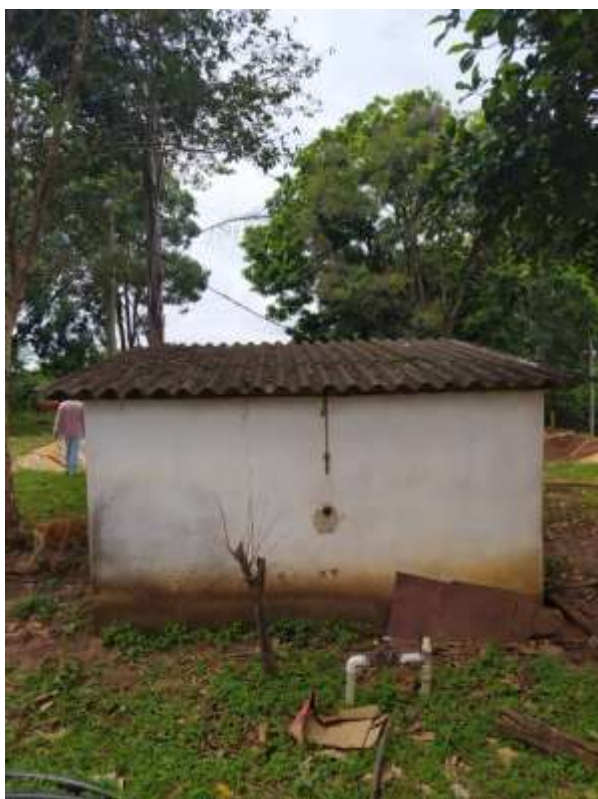
Figura 10 -- CÔMODO EDIFICADO 2 ( A= 11,00 \text{ m}^2 ) - LIGAÇÃO DESATIVADA DE POÇO ARTESIANO
