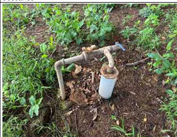
Imagem 18. Vista do poço semi artesiano
