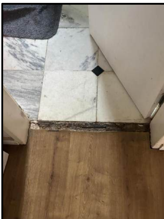
Foto 123: Suíte - sem acabamento na troca de piso
