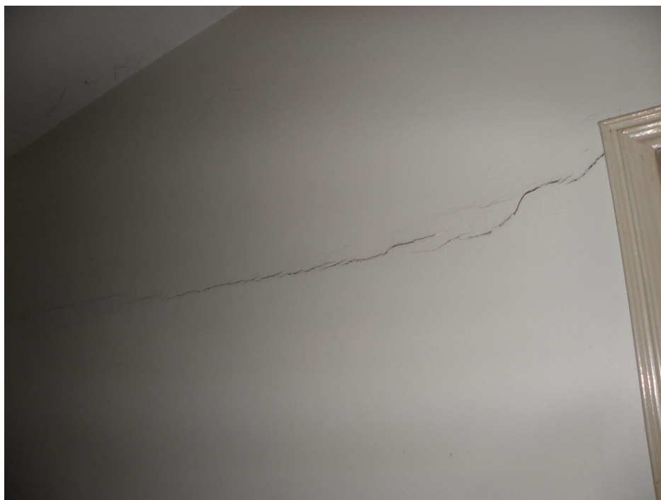
Foto: rachadura sem risco estrutural.
