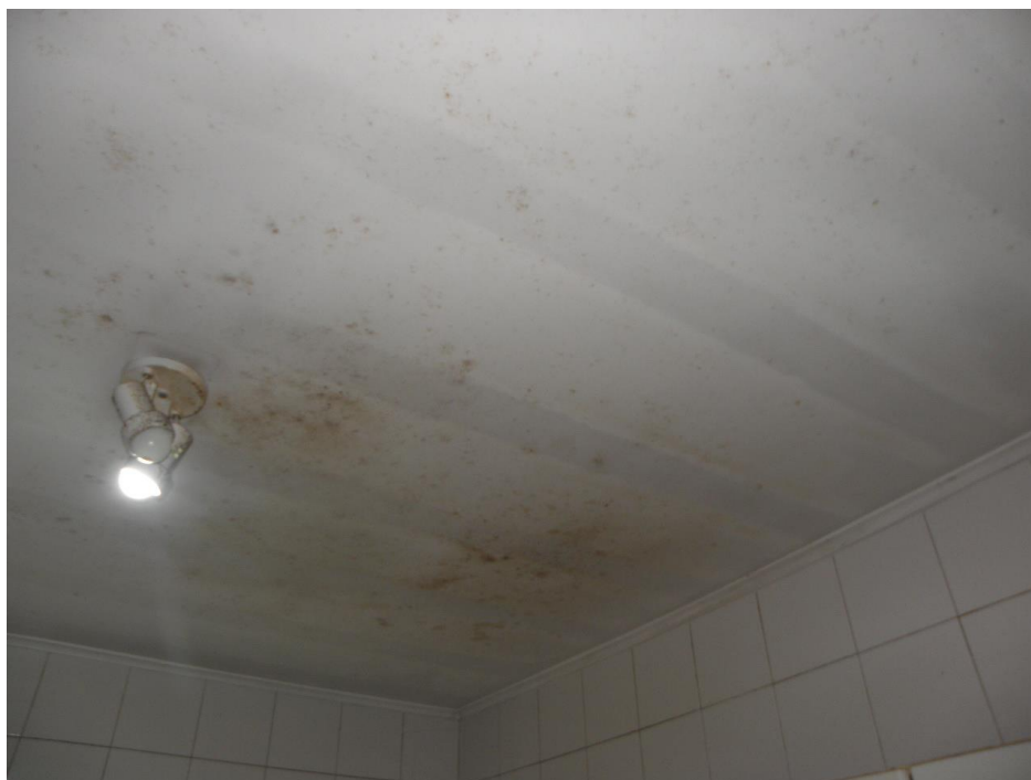
Foto: teto da cozinha com sinais de infiltração.
