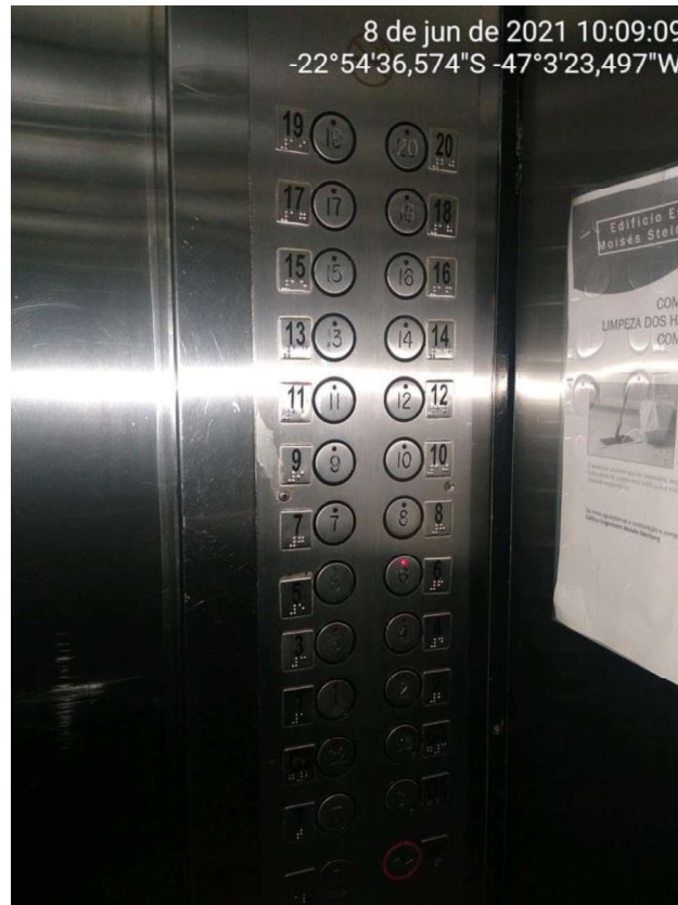
FOTO 09 – PAINEL DO ELEVADOR
