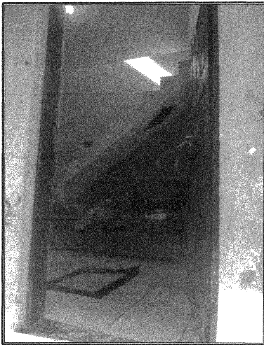
Vista parcial da sala da residência padrão simples, destacando o piso cerâmico e paredes necessitando pintura interna e acabamento externo.
