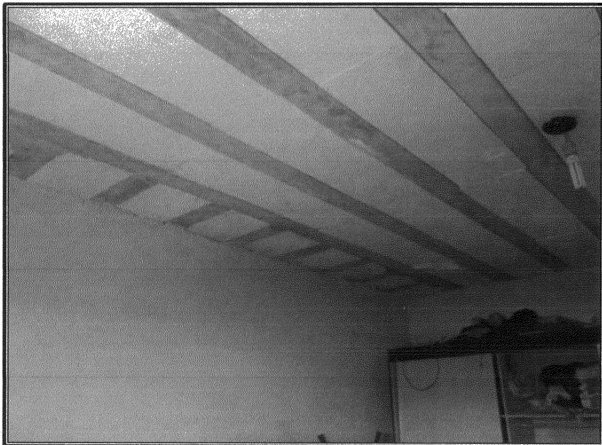
Foto de outro quarto, destacando a laje necessitando de acabamentos.
