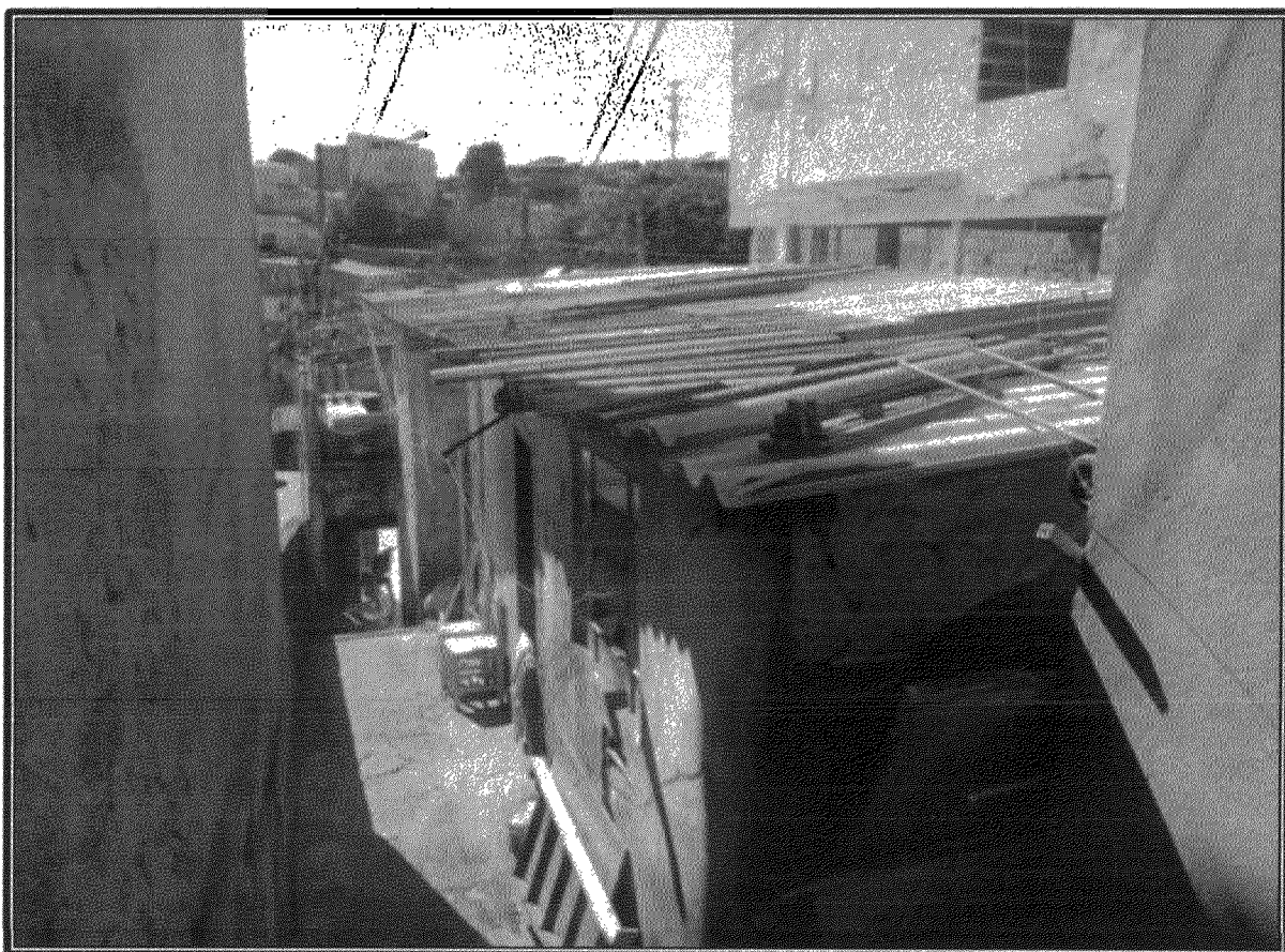
Vista parcial externa da edificação térrea padrão econômico necessitando de reparos e pintura.
