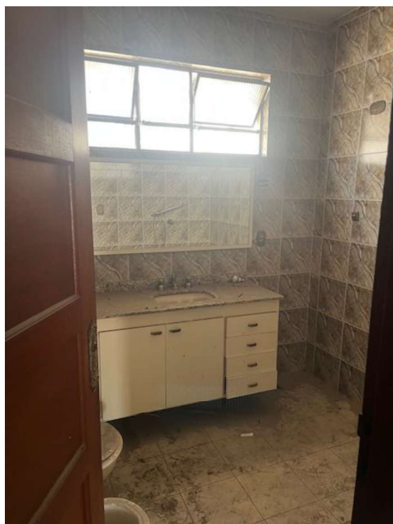
FOTO 28 – BANHEIRO – SEGUNDO PAVIMENTO
