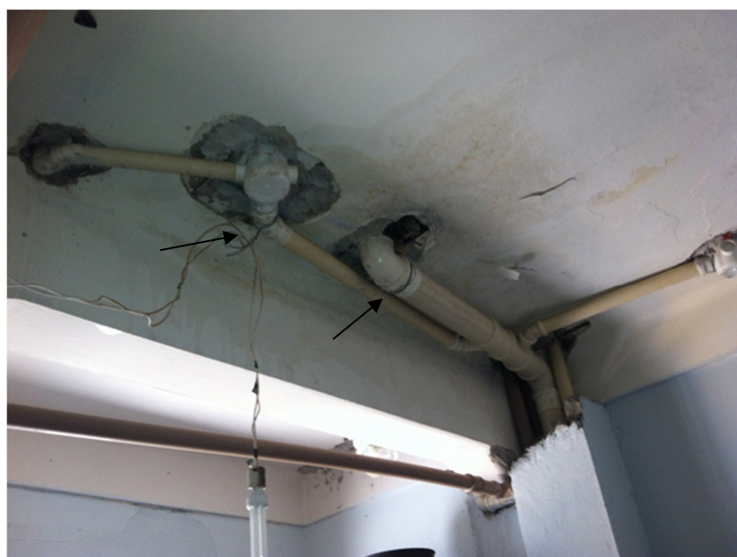
Figura 02. Instalações de esgoto do imóvel 31 aparentes no imóvel 21 e com falhas de execução.
