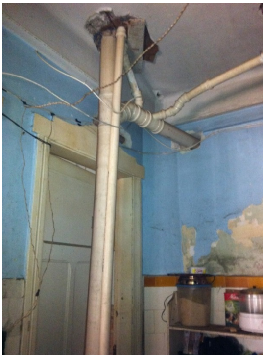
Figura 03. Instalações de esgoto improvisadas, coluna de esgoto da edificação passando no meio da cozinha do imóvel 21.
