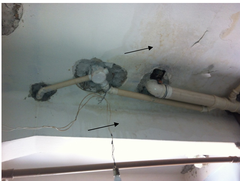
Figura 04. Infiltração de água no teto do dormitório – imóvel 21.
