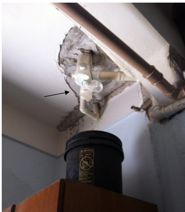
Figura 01. Ponto de vazamento devido à falha de execução ou anomalia na conexão de PVC da instalação de esgoto do imóvel 31.
