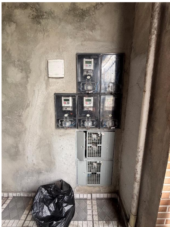
Foto 06 – medidores de energia e água individualizados
