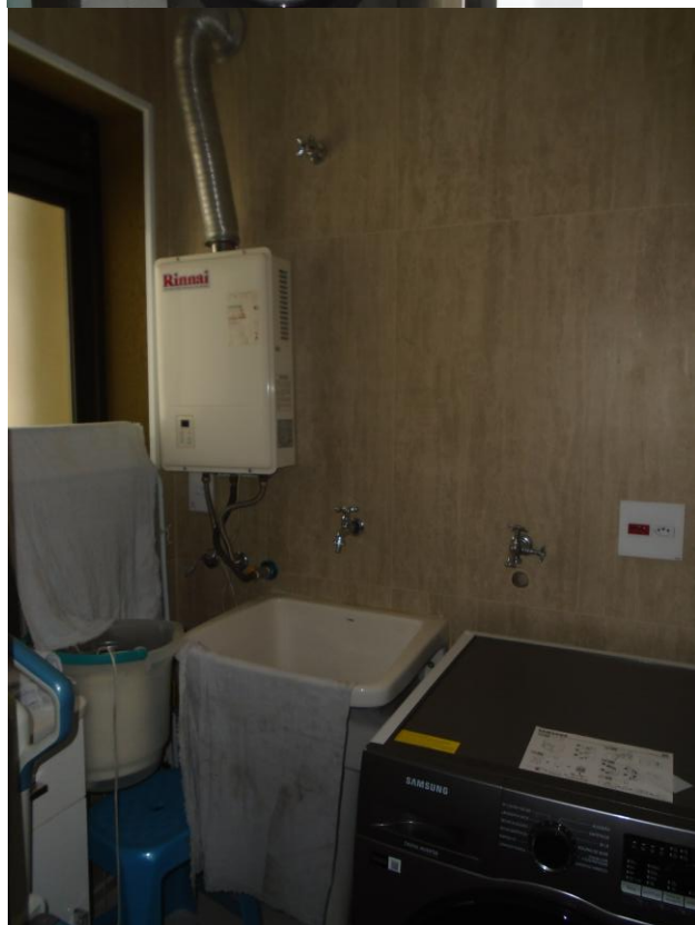
FOTO 30 – AQUECEDOR PASSAGEM, TANQUE E MAQUINAS.
