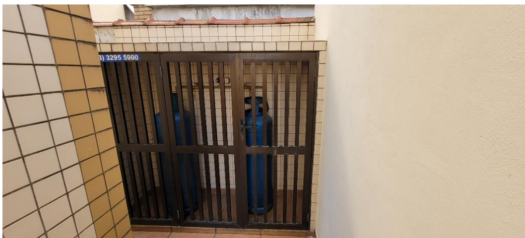
Foto 05: Abrigo para gás
