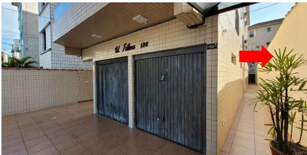
Foto 02: Garagens com porta basculante, na seta o muro sem revestimento cerâmico
