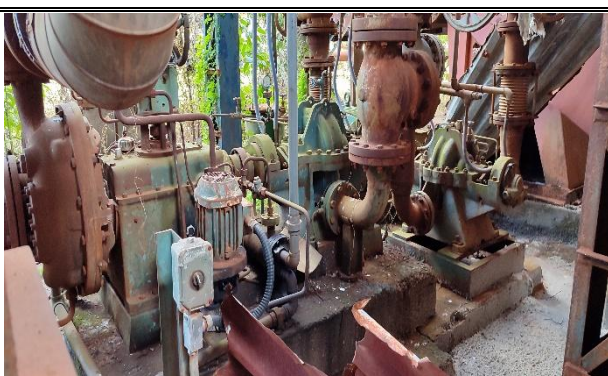
- Conjunto de válvulas –
