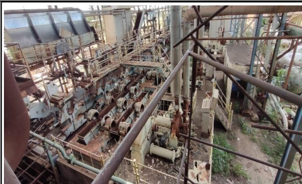
- Sistema de Tratamento de Cana –
