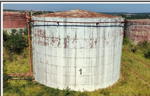
- Reservatório para Álcool –
