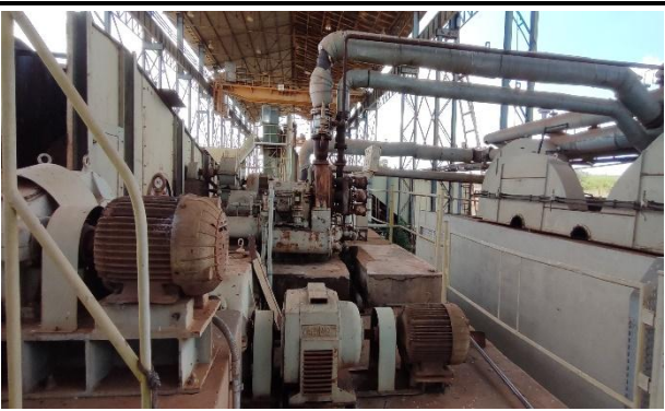
- Conjunto de Motobombas –
