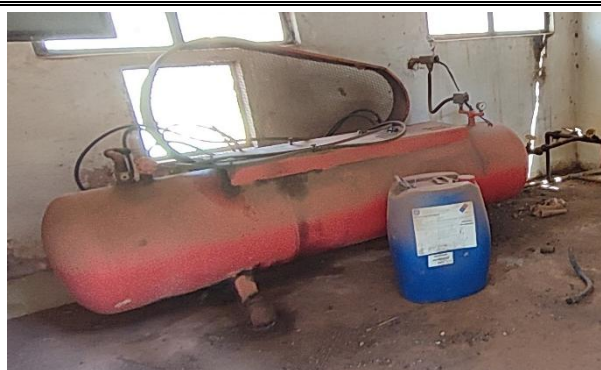
- Compressor de Ar -
