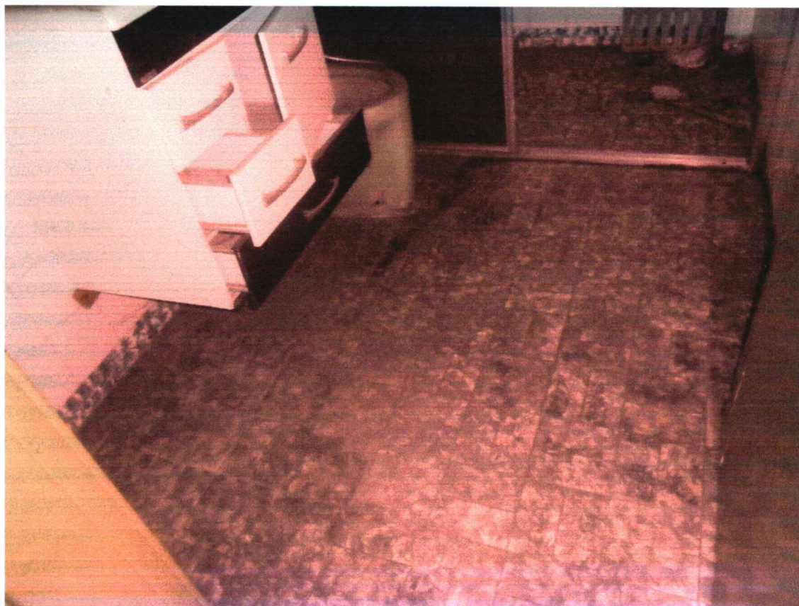
Piso do banheiro do apartamento objeto da presente ação
