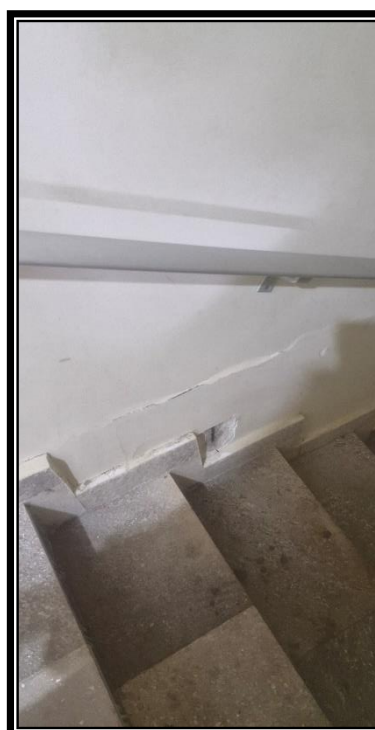
Figura 23 – Necessidade de manutenção no Edifício
