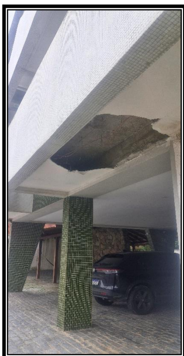
Figura 22 – Necessidade de manutenção no Edifício
