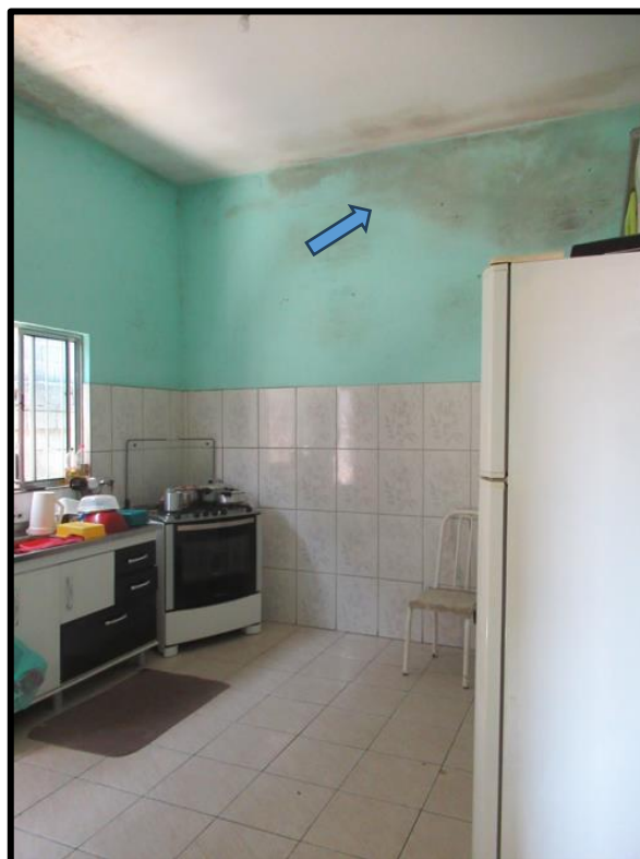
Foto 10: Cozinha - apresentando umidade
