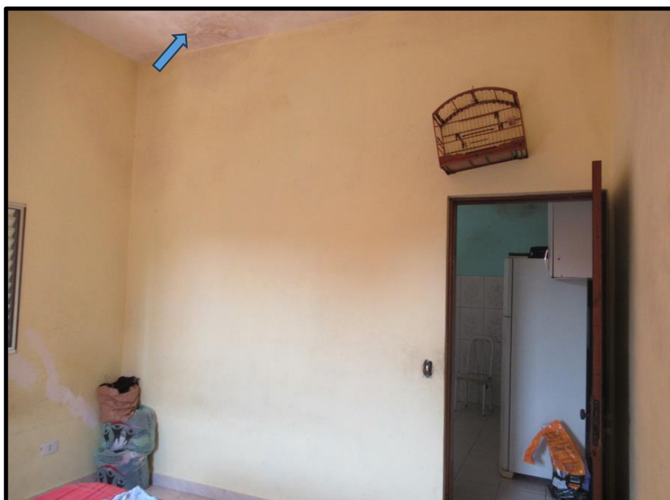
Foto 18: Quarto da criança - umidade no teto e parede
