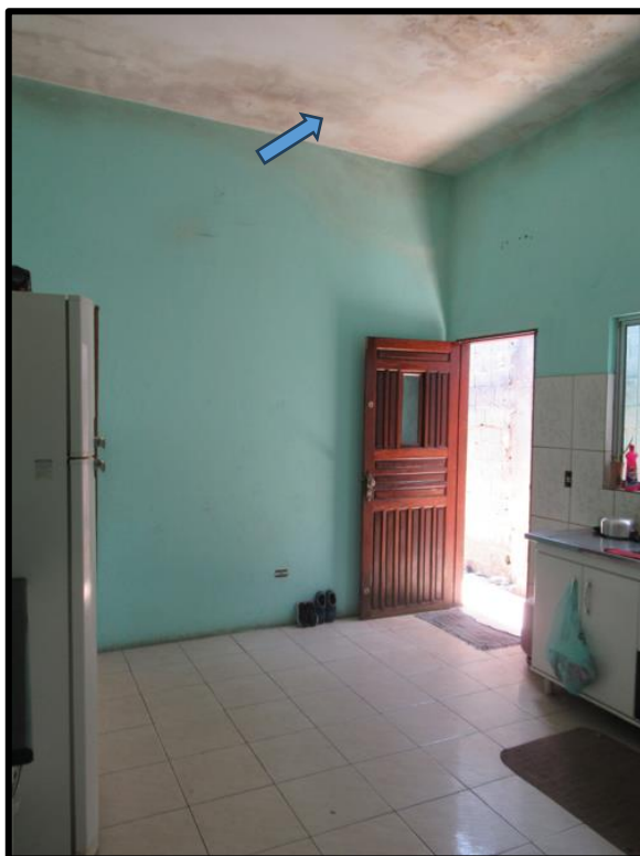
Foto 11: Cozinha - unidade por falta de impermeabilização e telhado
