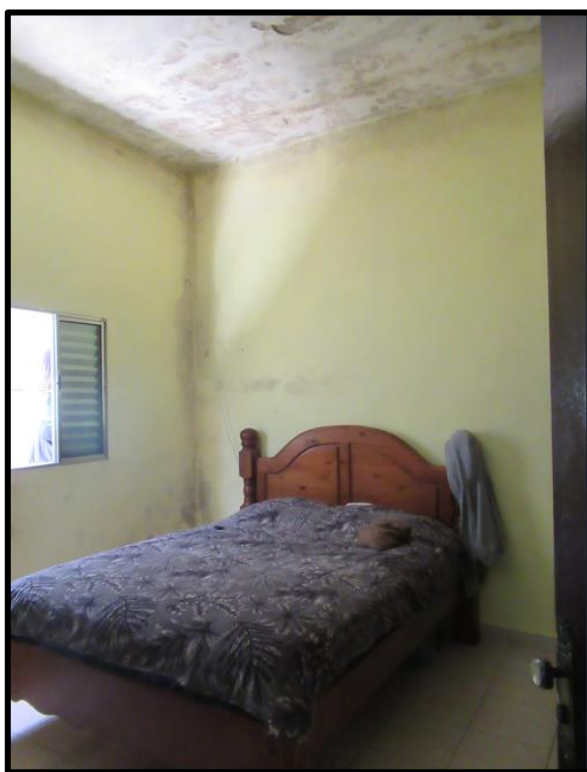
Foto 14: Quarto casal - umidade vinda da laje exposta
