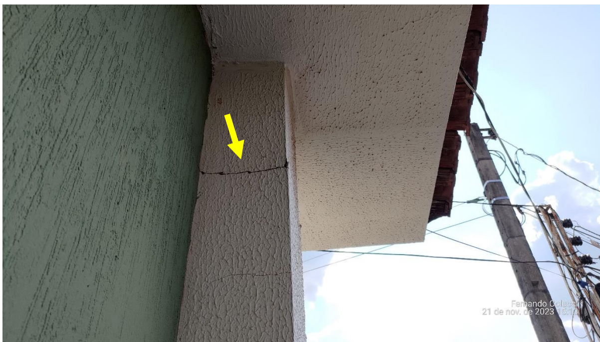
Figura 31 - Trinca no pilar externo
