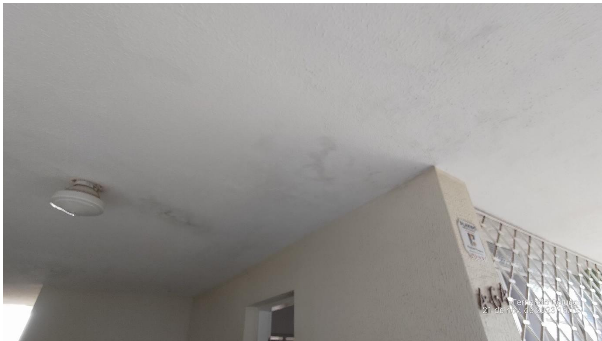
Figura 30 - Manchas na pintura da laje
