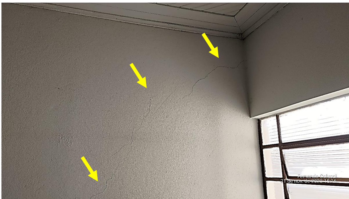
Figura 32 - trinca no quarto externo
