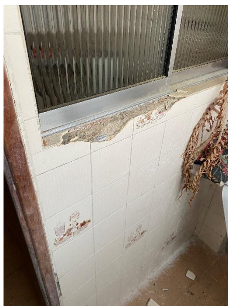
Imagem 26 - Vista de peças cerâmicas danificadas na área de serviço.
