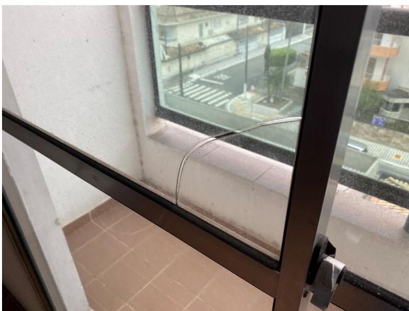
Imagem 16 - Vista de vidro trincado na porta-balcão da sala.
