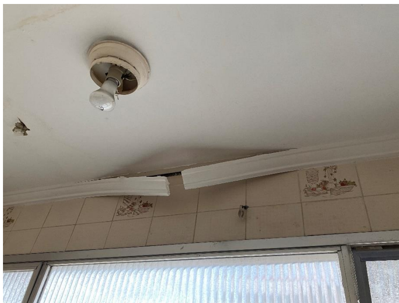
Imagem 23 - Vista de moldura de gesso solta no teto da área de serviço.
