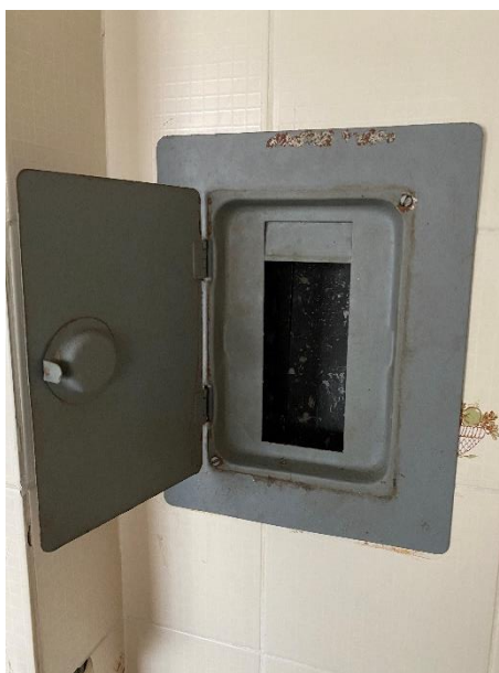
Imagem 21 - Vista de quadro de elétrica com componentes removidos.
