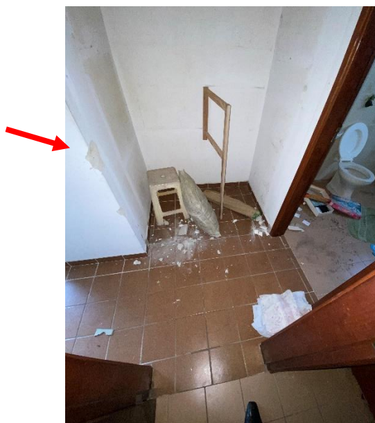
Imagem 29 - Vista de danos no emassamento da parede do corredor de acesso ao dormitório.
