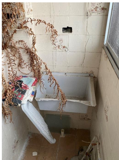
Imagem 25 - Vista de tanque danificado na área de serviço.
