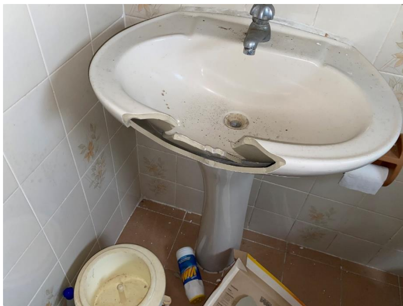
Imagem 33 - Vista de lavatório do banheiro danificado.
